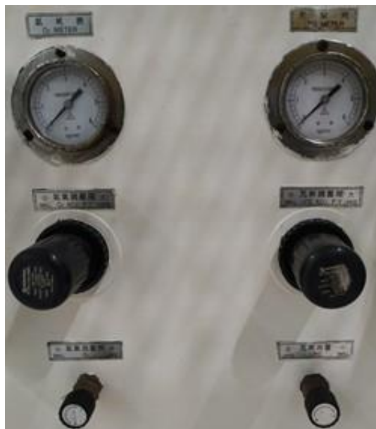
Figura 3.20- Reguladores de pressão e manómetros.
