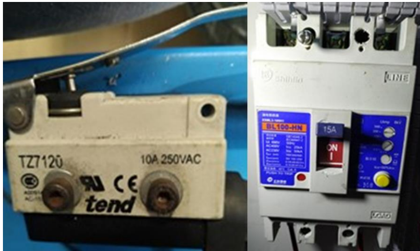
Figura 3.17 - Interruptor de pressão à esquerda e à direita interruptor de corte geral.
