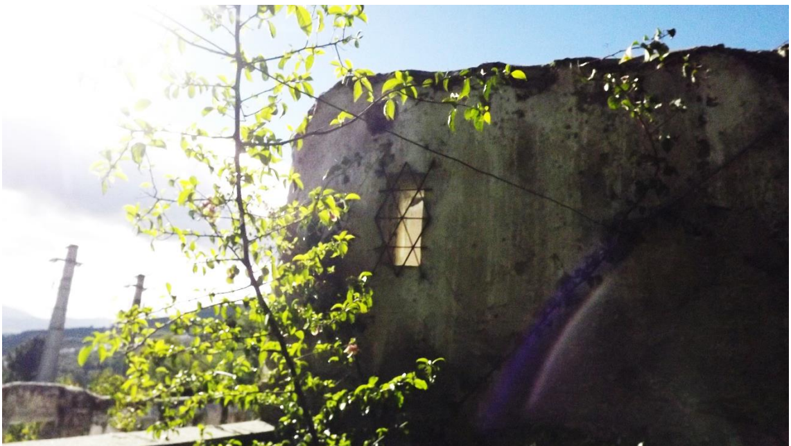
Figura 11: Apontamento da janela
