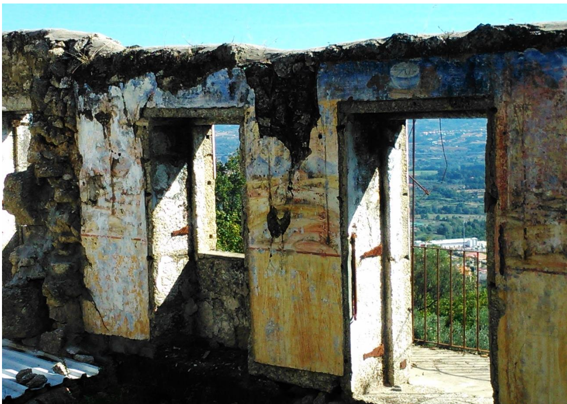
Figura 13: Apontamento dos vão a Sudeste e do reboco degradado
