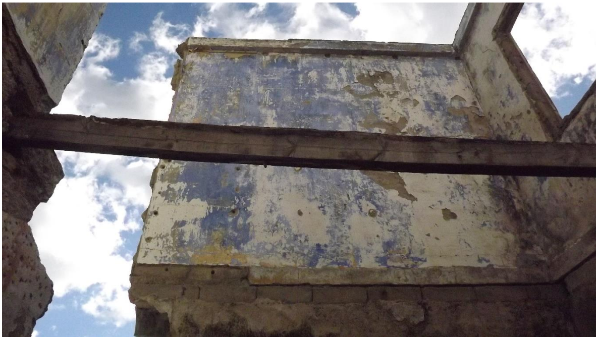
Figura 17: Apontamento da única vigota de madeira no volume de alvenaria de betão
