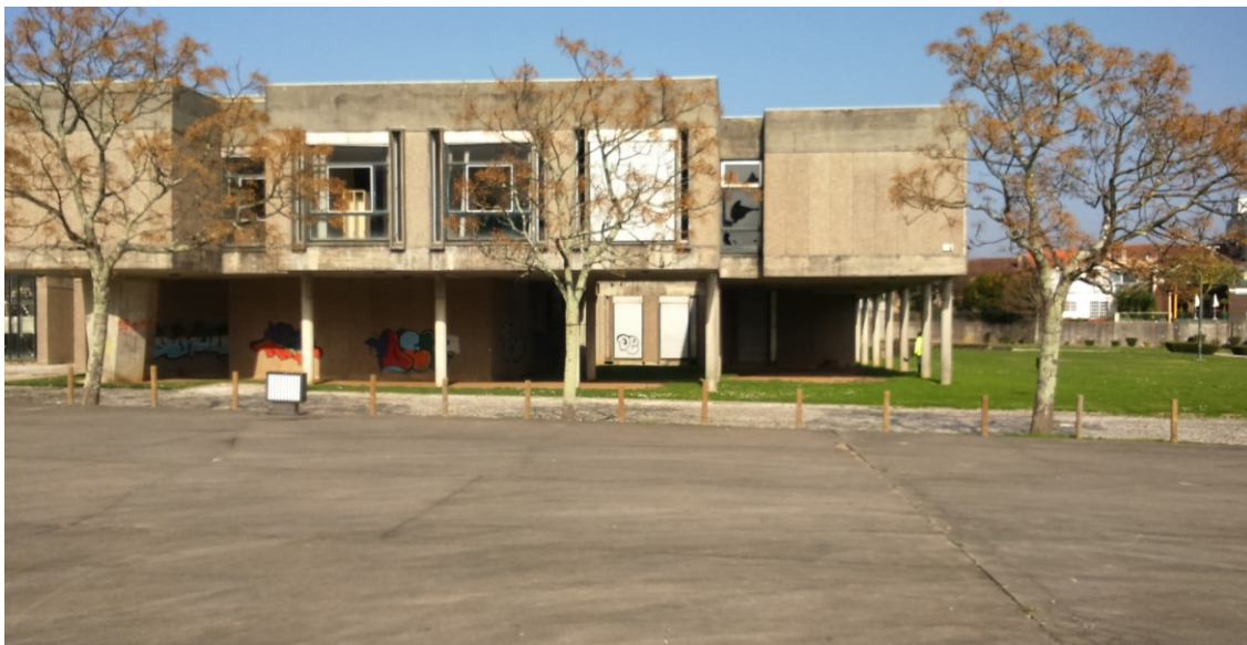
Figura 28 – Fotografia do edifício devoluto – fachada sudoeste.
