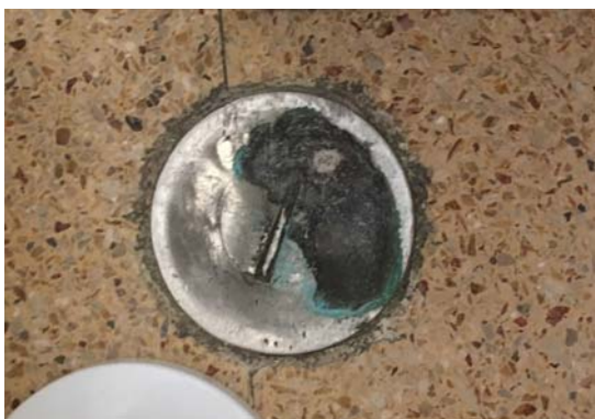
Sifão coletivo - instalação sanitária
