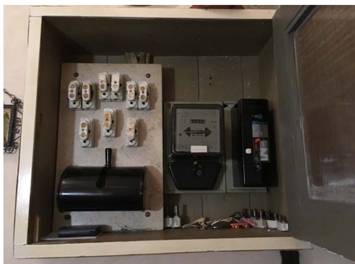
Contador e quadro elétrico - hall
