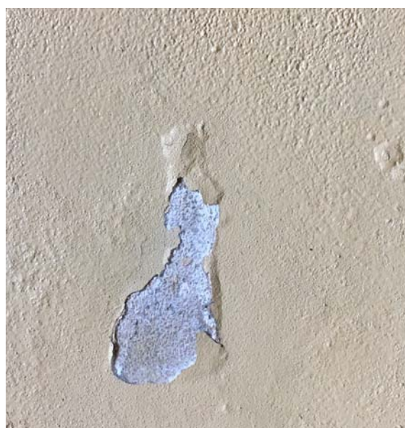
Destacamento de tinta
