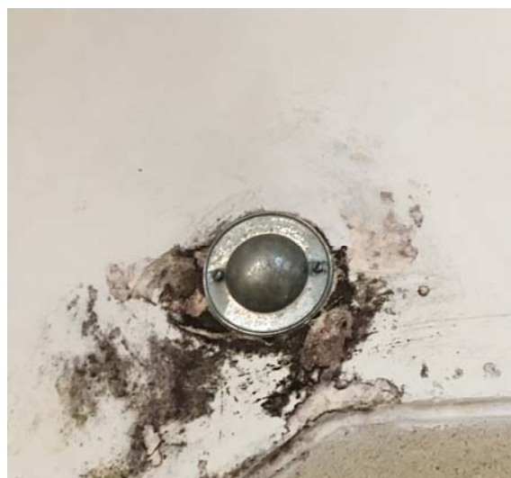
Humidade/escorrimento no ramal individual de água
