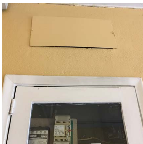
Instalações elétricas - QSC e QC
