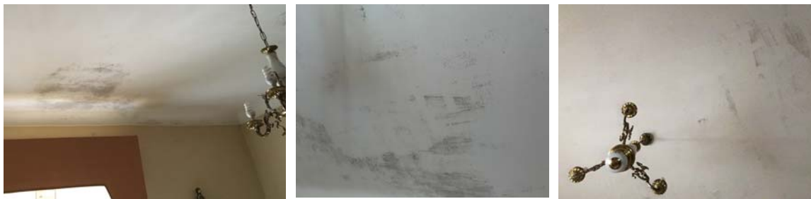
Humidade/condensações 3º Andar em contacto com desvão de cobertura
