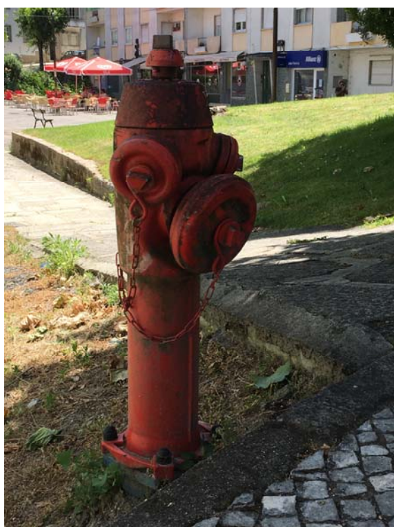
Marco de incêndio para abastecimento de veículos de bombeiros
