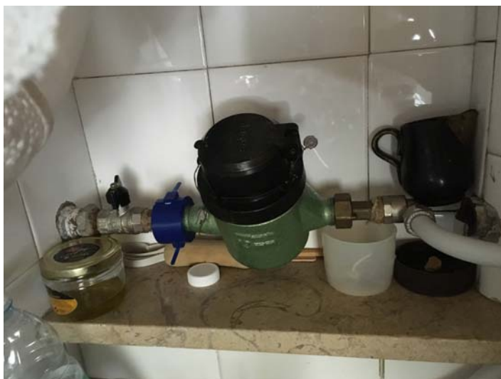
Contador de água - cozinha
