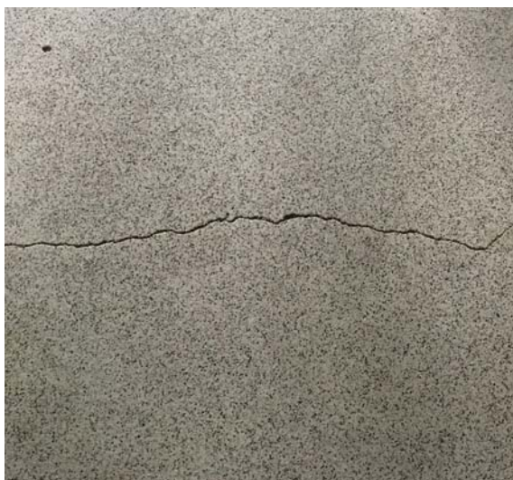
Fissura horizontal em pavimento
