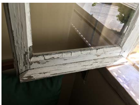
Caixilharia de madeira degradada
