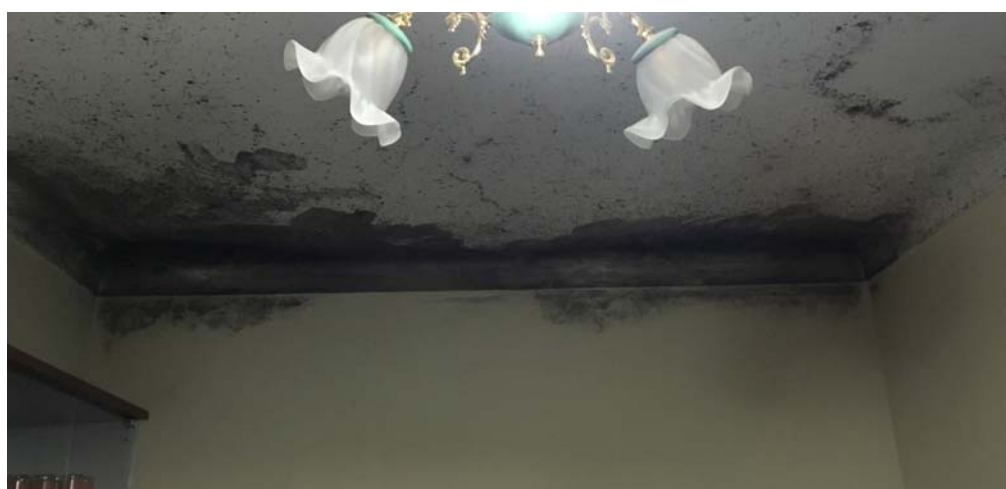
Humidade/condensações 3º Andar em contacto com desvão de cobertura
