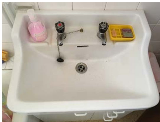
Ralo - instalação sanitária
