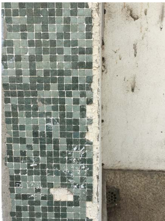
Destacamento de ladrilhos
