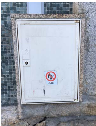
Tampa de gás encastrada
