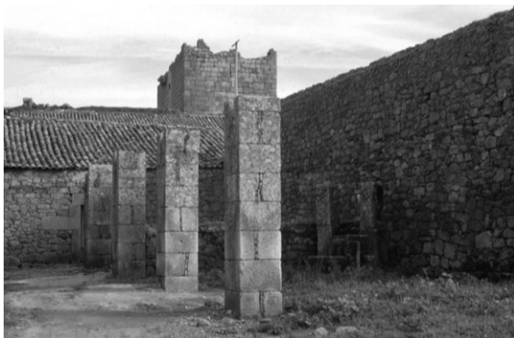
Fig. 50 Estado antes da intervenção
