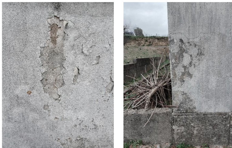
Figura 36| Destacamento do Reboco (parede exterior)
