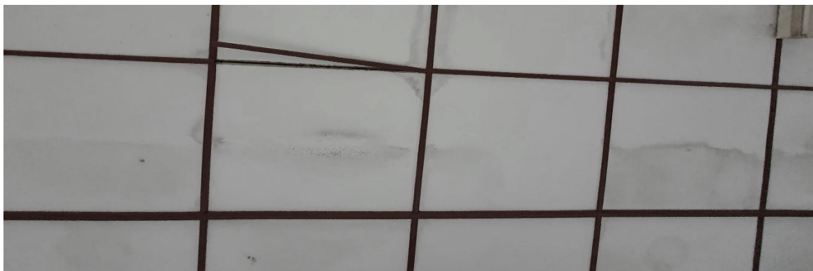
Figura 44| Estado atual do teto falso da sala de aula (janeiro 2025)
