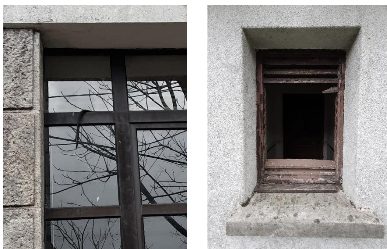
Figura 38| Estado atual de um vão do alçado frontal (janeiro 2025)
