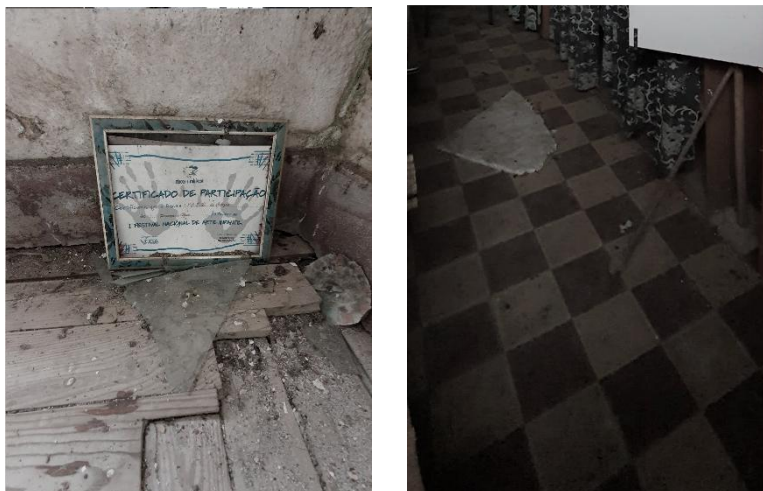
Figura 42| Patologias no pavimento interior da sala de aula (janeiro 2025)
