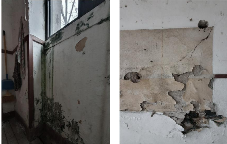
Figura 40| Estado Atual parede interior da sala de aula (janeiro 2025)
