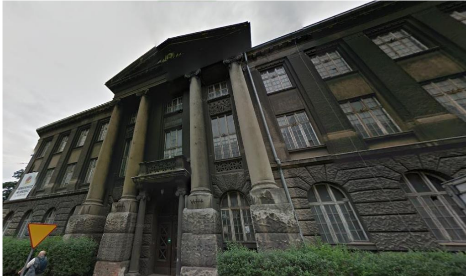
Figura 56 - Fachada suja de poluição, na rua 2 Józefa Mitręgi, Gliwice
