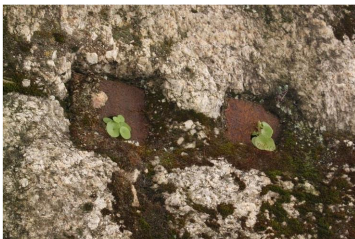
Figura 29 - Proliferação de vegetação em elementos de alvenaria e de ferro (autoria: Lara Pereira)
