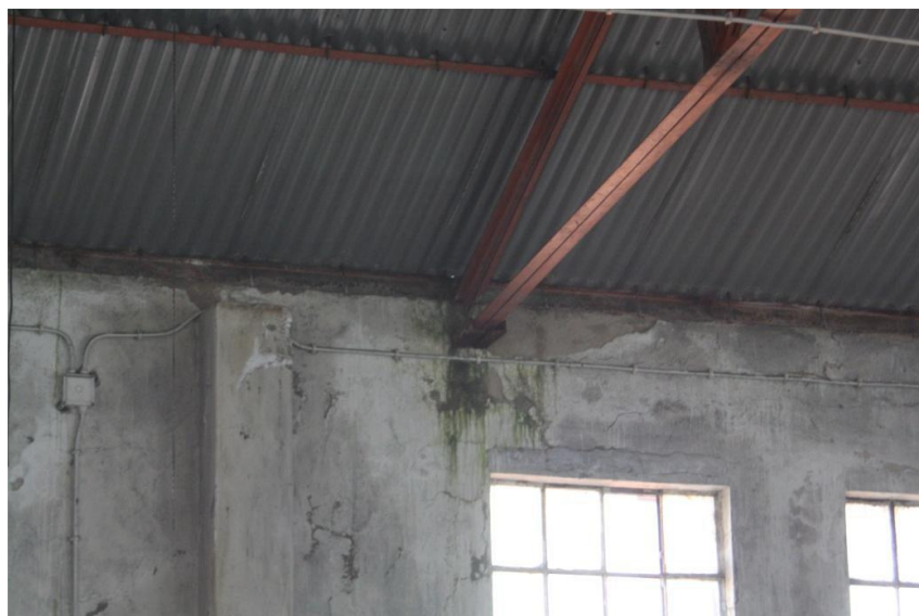
Figura 41 - Estrutura metálica da cobertura não assenta sobre os pilares (autoria: Lara Pereira)
