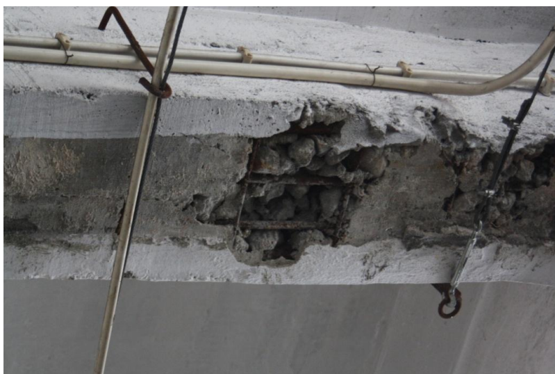
Figura 36 - Viga com integridade comprometida: armaduras à vista e má qualidade dos agregados empregues na sua execução (autoria: Lara Pereira)
