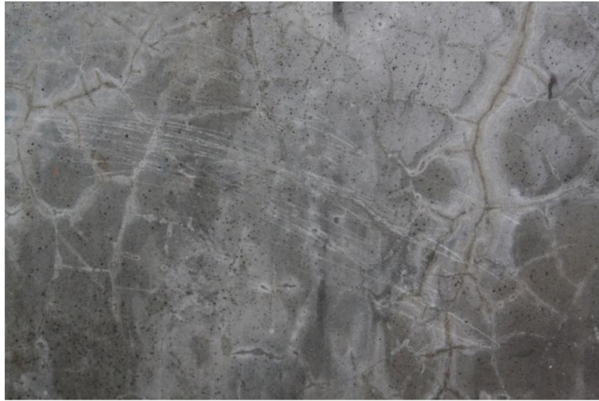
Figura 34 - Padrão de fissuração (autoria: Lara Pereira)
