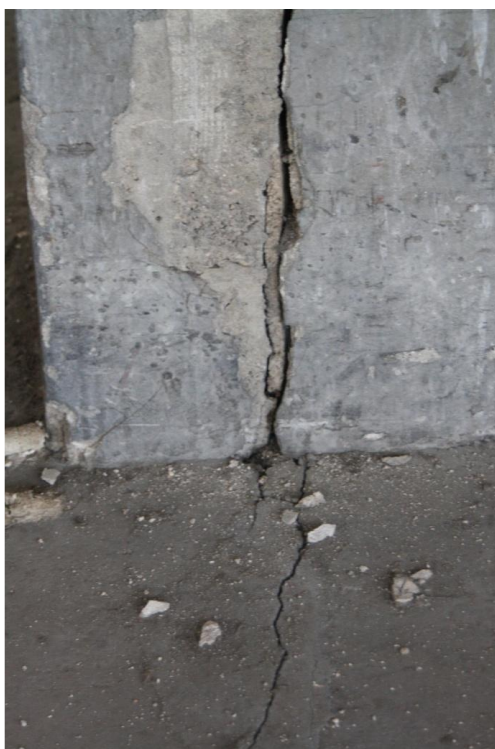
Figura 38 - Fratura contínua em pilar e laje (autoria: Lara Pereira)
