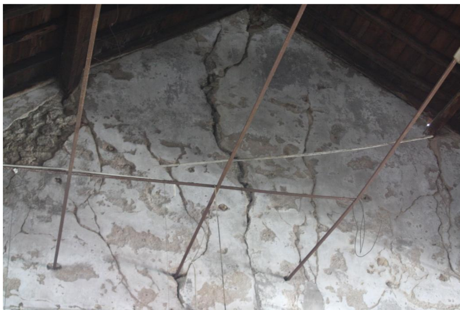
Figura 43 - Fraturas numa parede de alvenaria (autoria: Lara Pereira)
