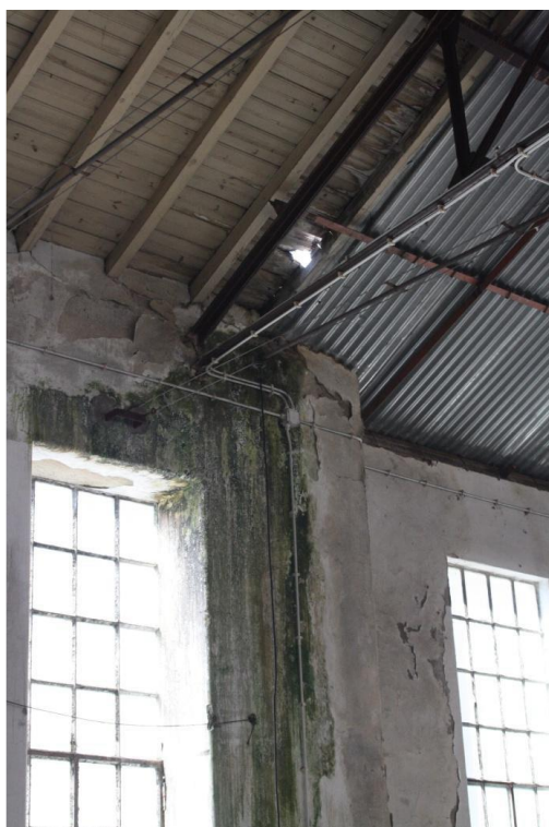
Figura 42 - Manchas devidas a infiltrações e mau estado da cobertura (autoria: Lara Pereira)
