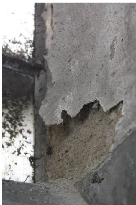
Figura 33 - Descasque da pintura e reboco por incompatibilidade com a alvenaria (autoria: Lara Pereira)
