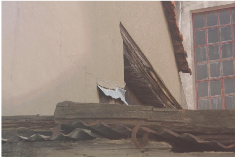
Figura 24 - Degradação de elementos de madeira da cobertura (autoria: Lara Pereira)
