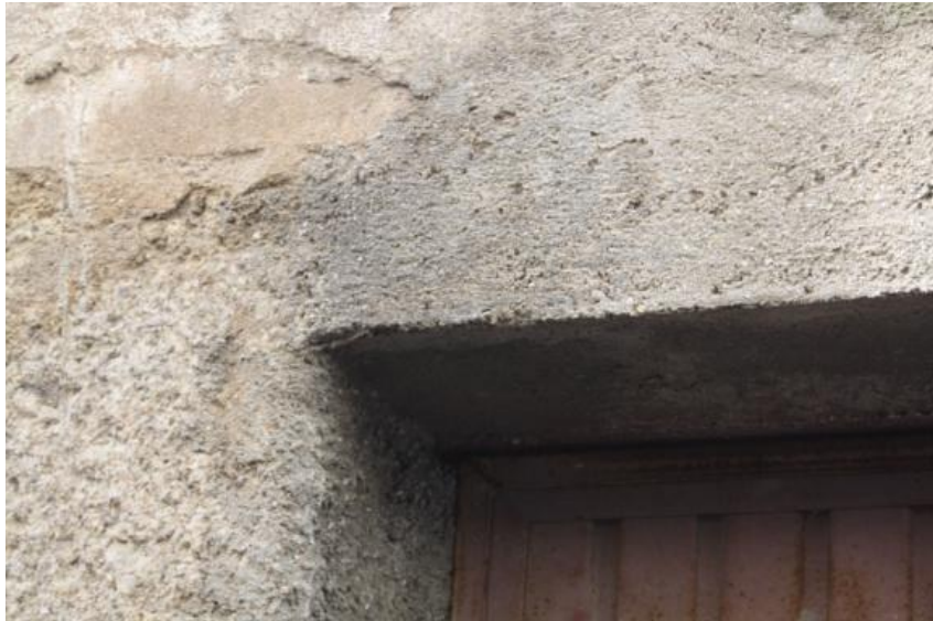
Figura 26 - Viga de encabeçamento de uma porta com extensão insuficiente para o bom cumprimento da sua função (autoria: Lara Pereira)
