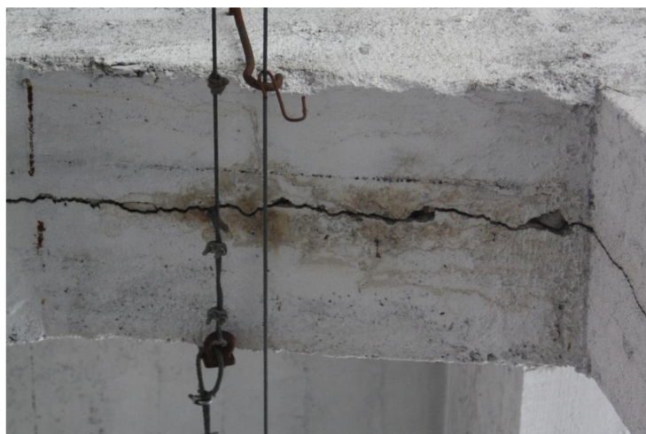
Figura 39 - Fratura contínua em viga onde se notam também manchas acastanhadas que podem significar oxidação e corrosão das armaduras (autoria: Lara Pereira)
