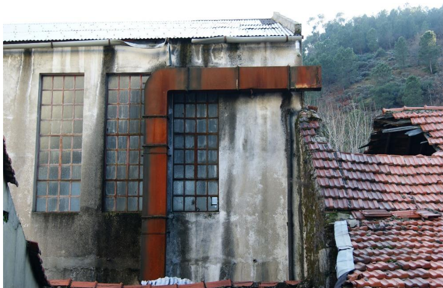
Figura 28 - Proliferação de elementos biológicos nas fachadas e mau estado do sistema de drenagem
