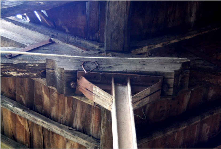
Figura 44 - Elementos de madeira apodrecidos e ligação a perfil metálico (autoria: Lara Pereira)
