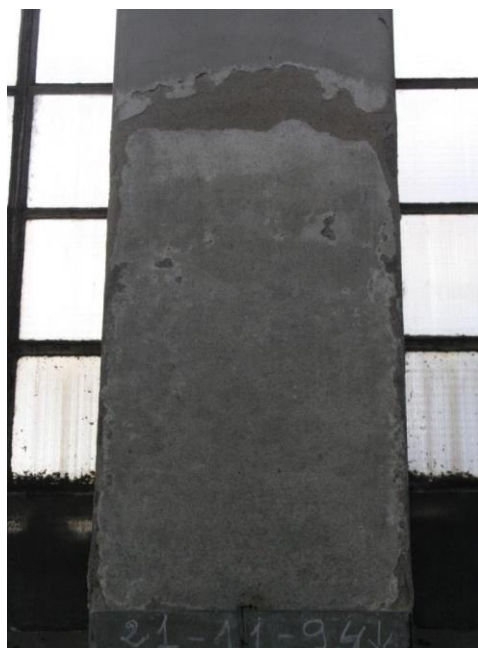
Figura 32 - Presença de eflorescências e humidade nos pilares e paredes da fachada Norte, pouco exposta à luz solar (autoria: Lara Pereira)
