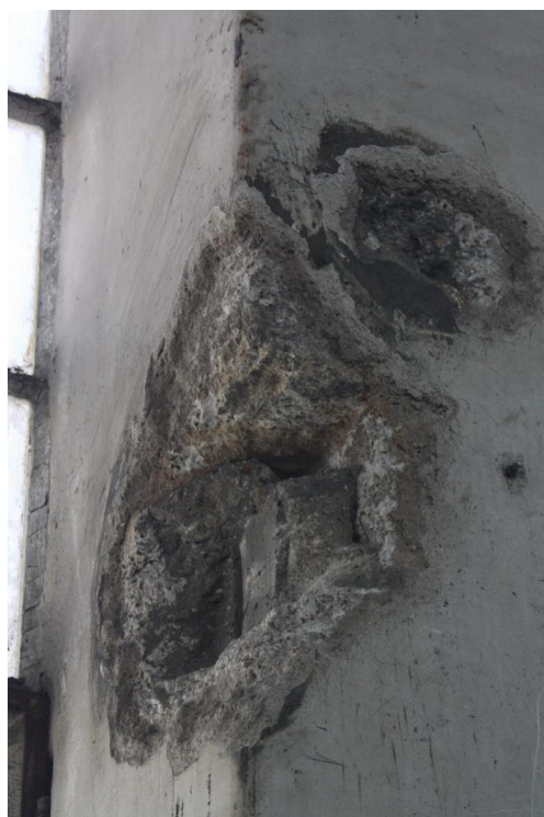
Figura 40 - Grandes buracos em paredes de alvenaria estrutural (autoria: Lara Pereira)
