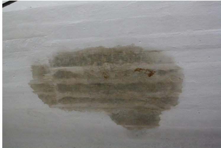
Figura 30 - Mancha de humidade presente em várias regiões do edifício, devido as infiltrações de água (autoria: Lara Pereira)
