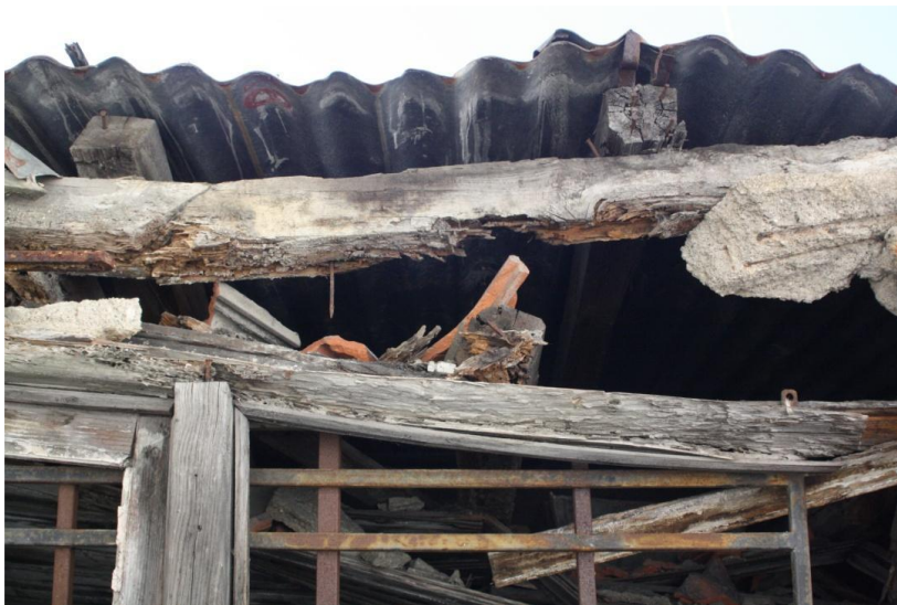
Figura 25 - Degradação de elementos de madeira e metal diversos, quer da cobertura (autoria: Lara Pereira)
