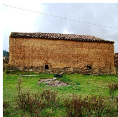
Figura 33 - Edifício em taipa sem juntas.
