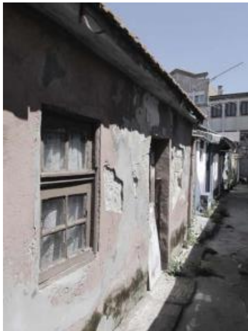
Figura 31 Ilha no Bonfim em estado de degradação 132
