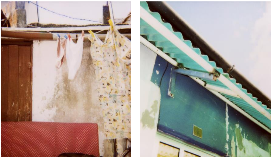
Figura 34 Paredes degradadas em casas de ilha 135
