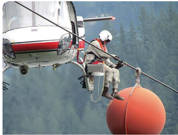
Figura 2.21: Esferas de alta visibilidade em linhas de alta tensão [60].
