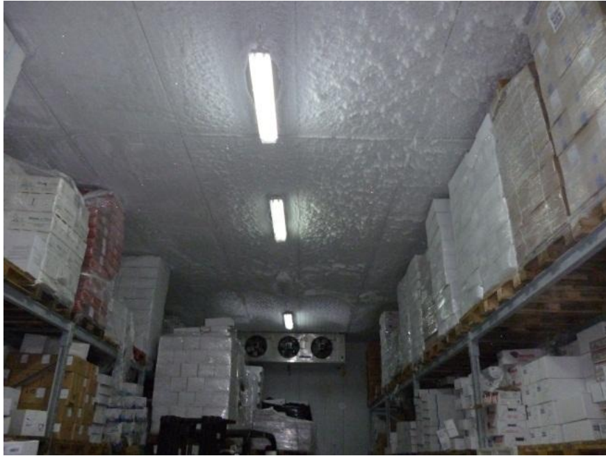
Figura 4.4 - Câmara de congelação construída na zona nova com pé-direito de 5 metros.
