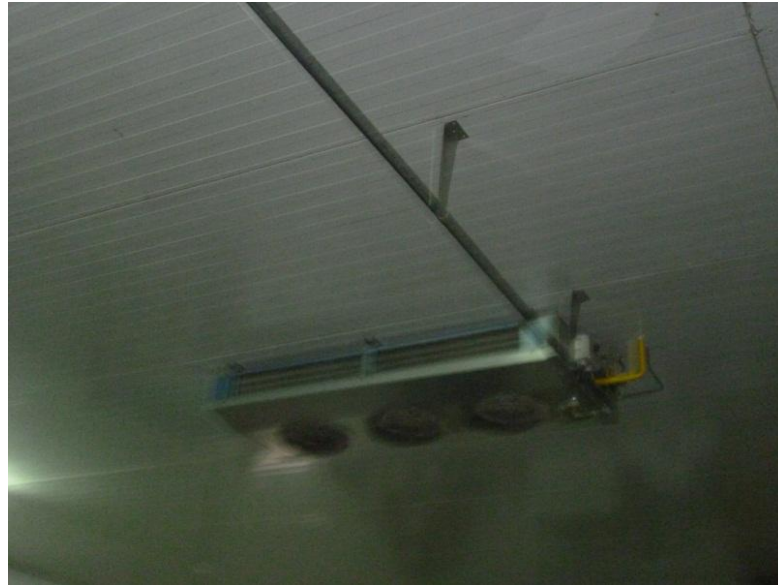
Figura 4.6 - Unidade de teto que climatiza a zona de distribuição.
