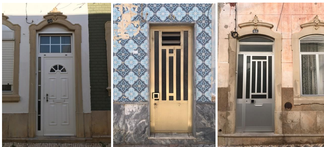
Figura 122 - Exemplos de fachadas descaracterizadas com revestimentos de azulejo e portas e janelas de alumínio.
