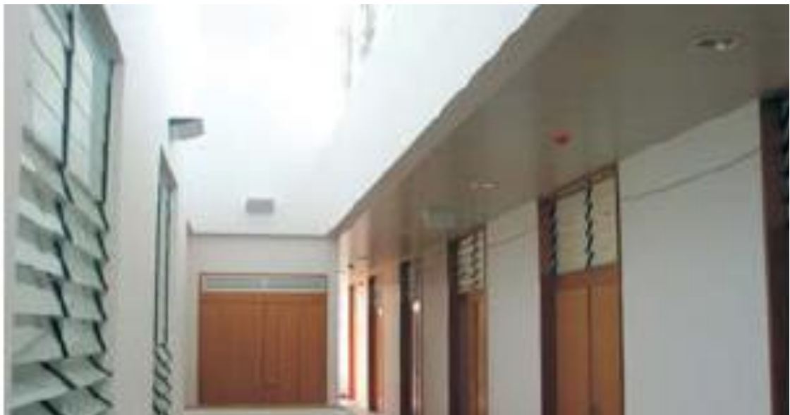
Figura 105 - Vista do Edifício Solar XXI – clarabóia de ventilação [Fonte: INETI, 2009]
