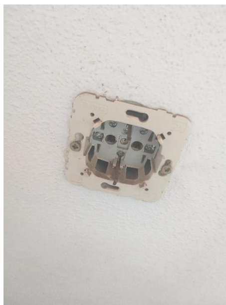
Figura 41 - Tomada danificada e sem proteção
