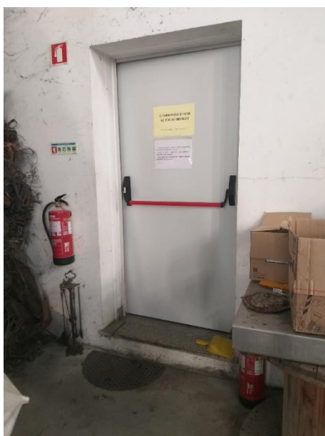
Figura 33 - Porta de emergência sem rampa de acesso
