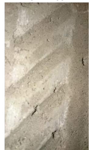
Esmagamento de betão nas bossas – CP.1.H60
