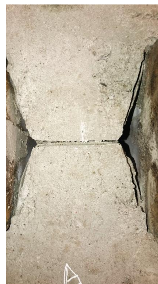
Figura 106 - Vista superior - CP.3.NSP após rotura
