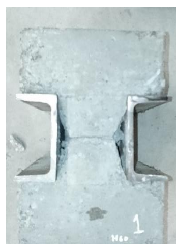
Figura 98 - Vista superior -CP.1.H60 após rotura
