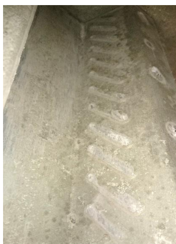
Figura 97 - Interface no aço - CP.1.H60 após rotura
