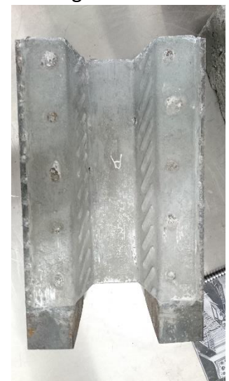
Parte metálica após rotura- CP.1.H60
