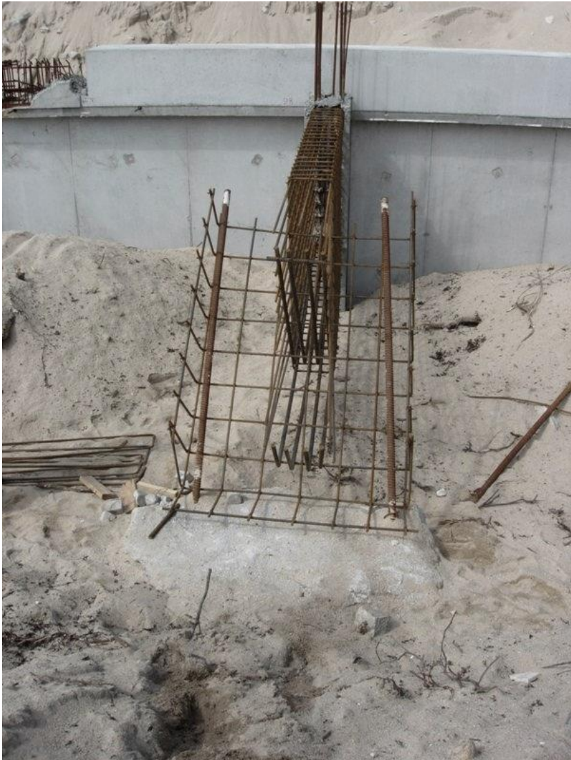
Fig. 145 | Parede contraventada por tímpanos, 2003
