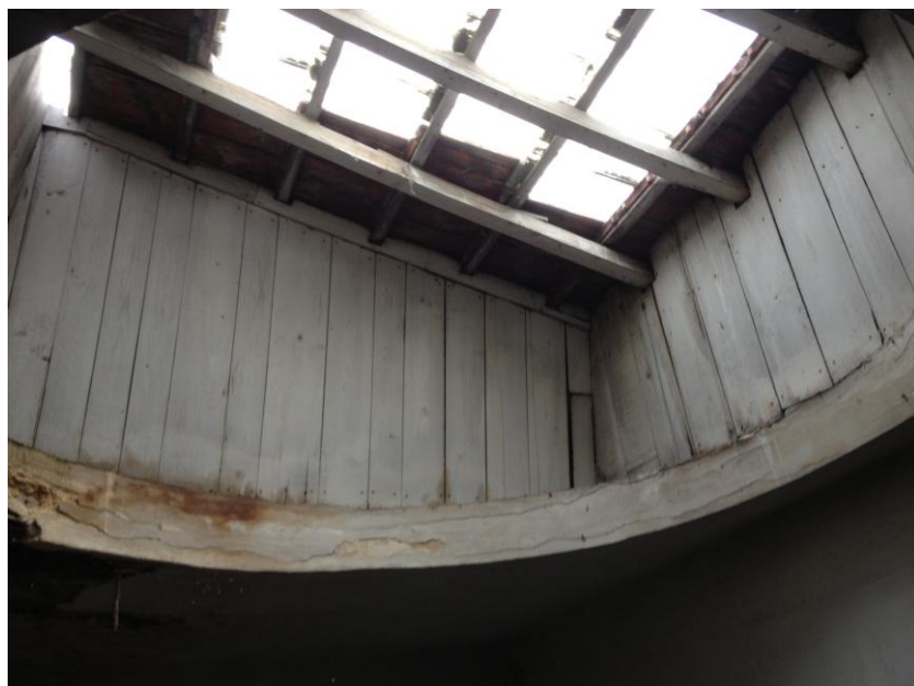
Fotografia 8: Cobertura antiquada e degradada antes de ser removida.
