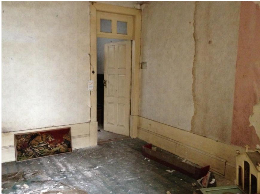
Fotografia 3: Estado degradado do interior do edifício.
