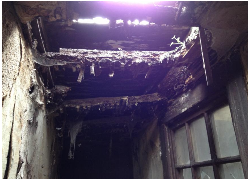
Fotografia 7: Mau estado da laje e cobertura.
