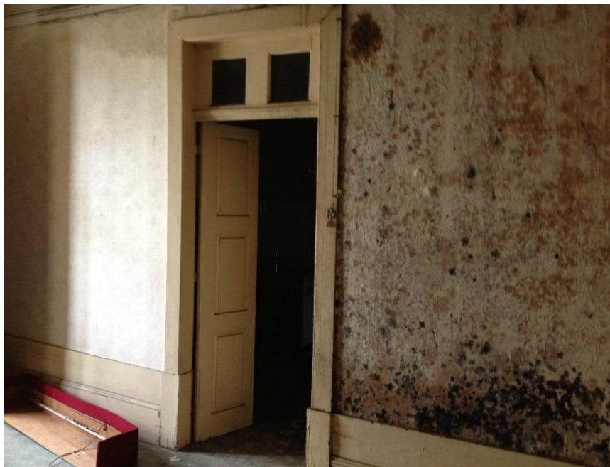
Fotografia 4: Estado degradado do interior do edifício.
