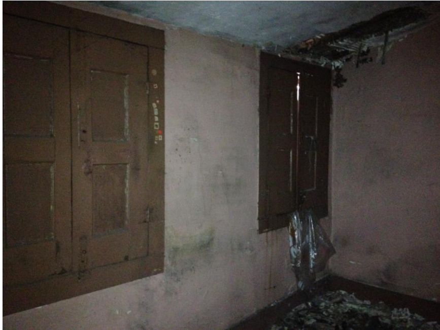
Fotografia 2: Estado degradado do interior do edifício.
