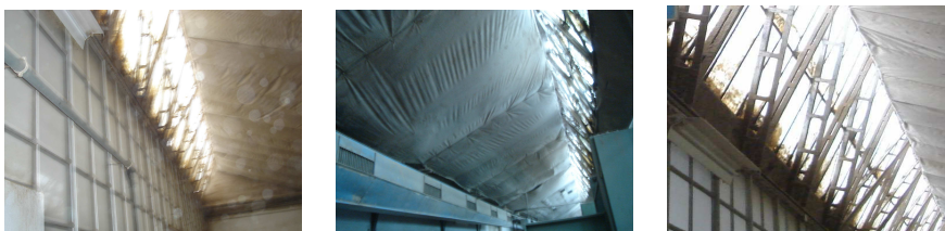
Figura 37 – Iluminarias naturais da empresa Covilan
