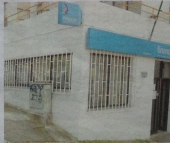
Vidro da porta principal foi quebrado com uma pedra
