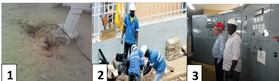
Fig. 3.18 - (1) Posto de energia quebrado, (2) técnicos os cabos na via publica, (3) Visita do autor à central termoelétrica do Xitoto Namibe. Fonte: do Autor
