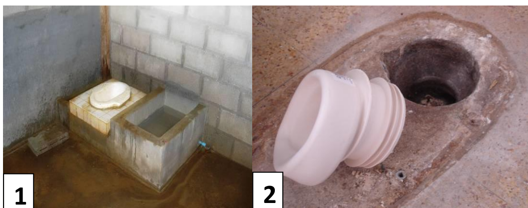
Fig. 4.28 - As imagens apresentadas são de sanitas construídas de betão armado, no interior do WC. Fonte: (Sanita, excêntrico, é necessário vedar? 2014 )
