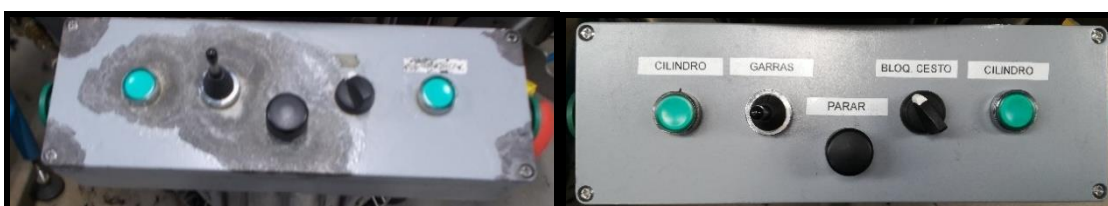
Figura 16 – Processo de 5S nos painéis de controlo
