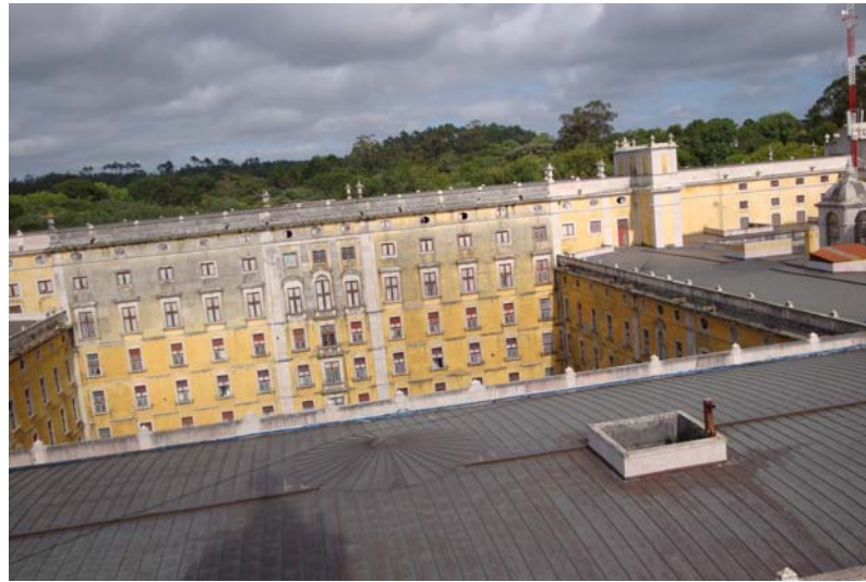
Imagem 36: Vista do terraço (ao centro encontra-se a biblioteca), Maio 2009 (foto de autor)
