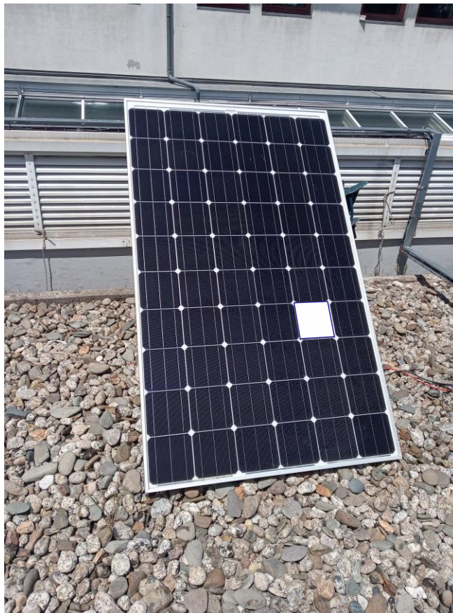
Figura 2.13 – Painel PV utilizado para medições experimentais com e sem sombreamento parcial.
