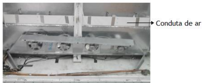
Fig. 20 - Conduta de ar
