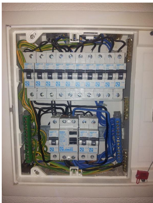
Figura 4.4 - Quadro geral da habitação sem proteções.
