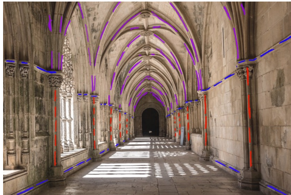
Figura 3.11: Interior do claustro de D.João I no Mosteiro da Batalha, com esquema dos referenciais verticais (vermelho), horizontais (azul) e curvos (púrpura)
