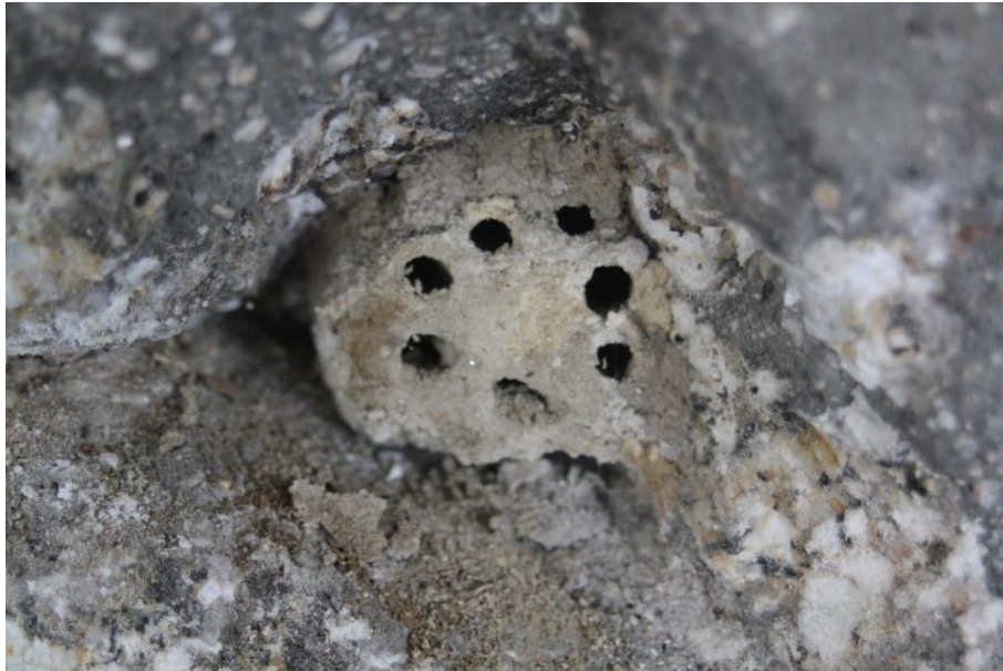
Figura 78 – Vespeiro presente na junta de blocos de alvenaria estrutural
