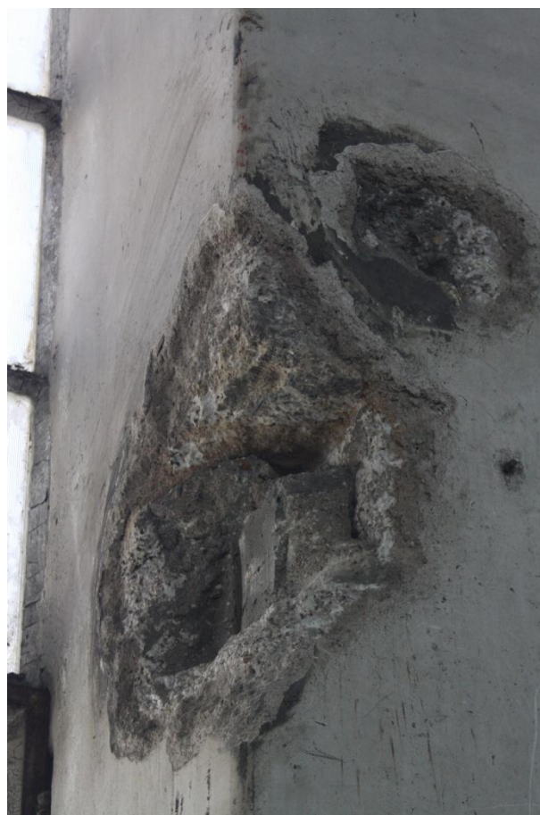
Figura 81 – Grandes buracos em paredes de alvenaria estrutural
