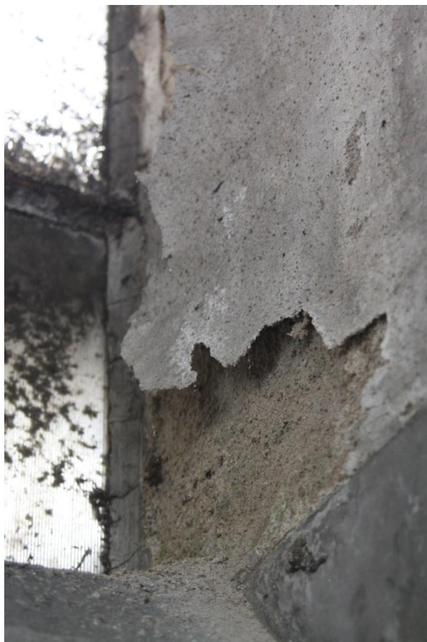
Figura 73 – Descasque da pintura e reboco por incompatibilidade com a alvenaria
