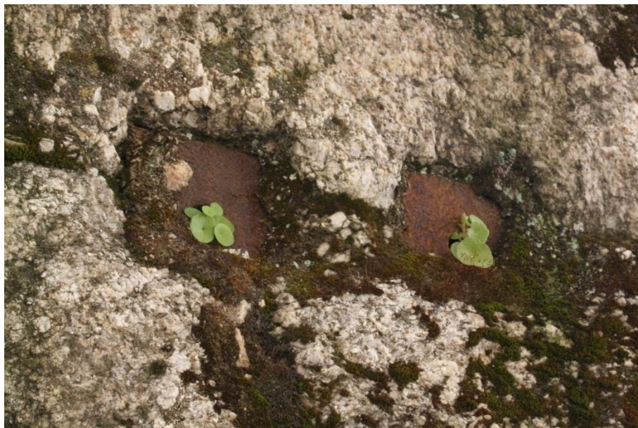
Figura 69 – Proliferação de vegetação em elementos de alvenaria e de ferro
