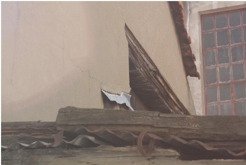
Figura 62 – Degradação de elementos de madeira da cobertura
