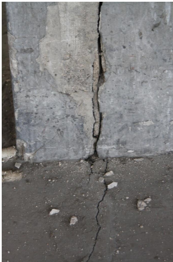
Figura 79 – Fractura contínua em pilar e laje
