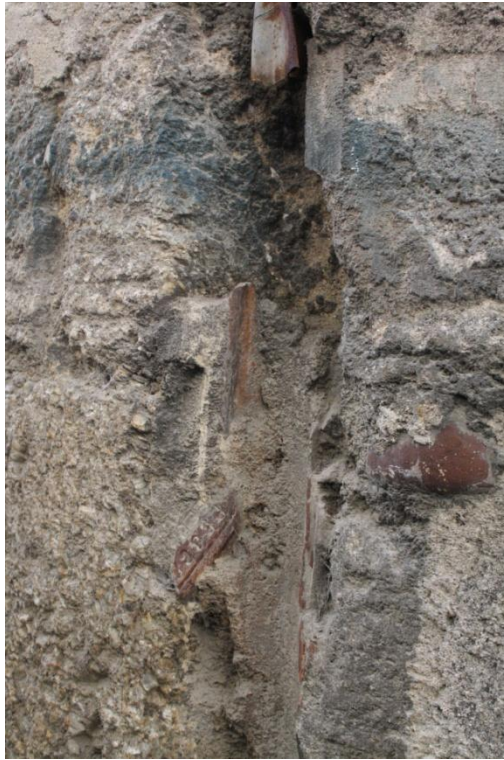
Figura 64 – Presença de um qualquer elemento de tubagem que se encontrava cravado na alvenaria e que se degradou.
