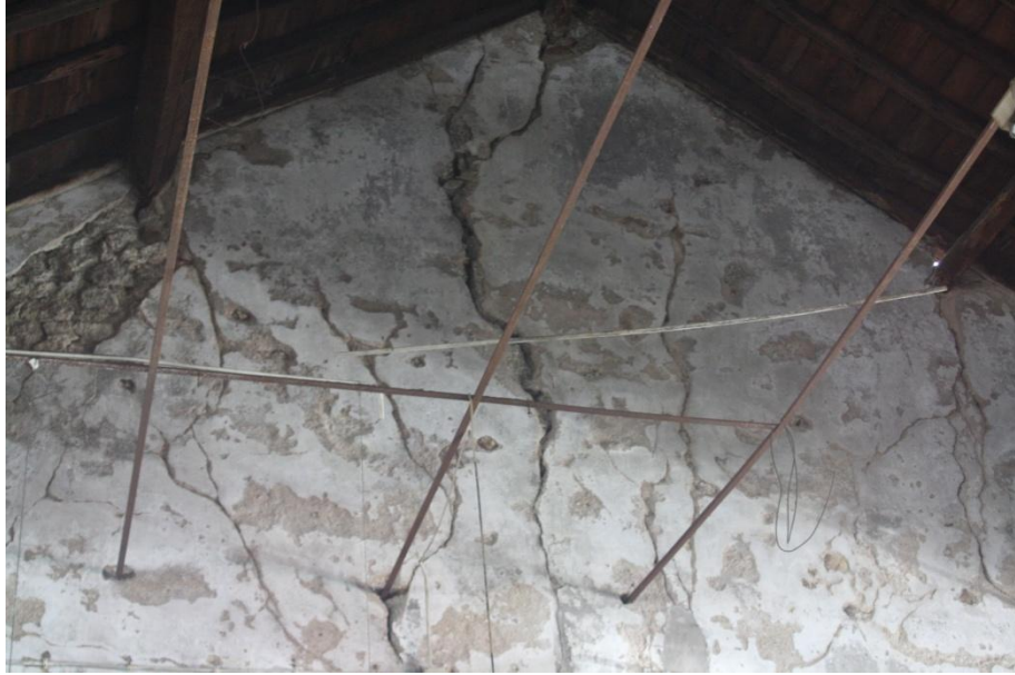
Figura 84 – Fracturas numa parede de alvenaria
