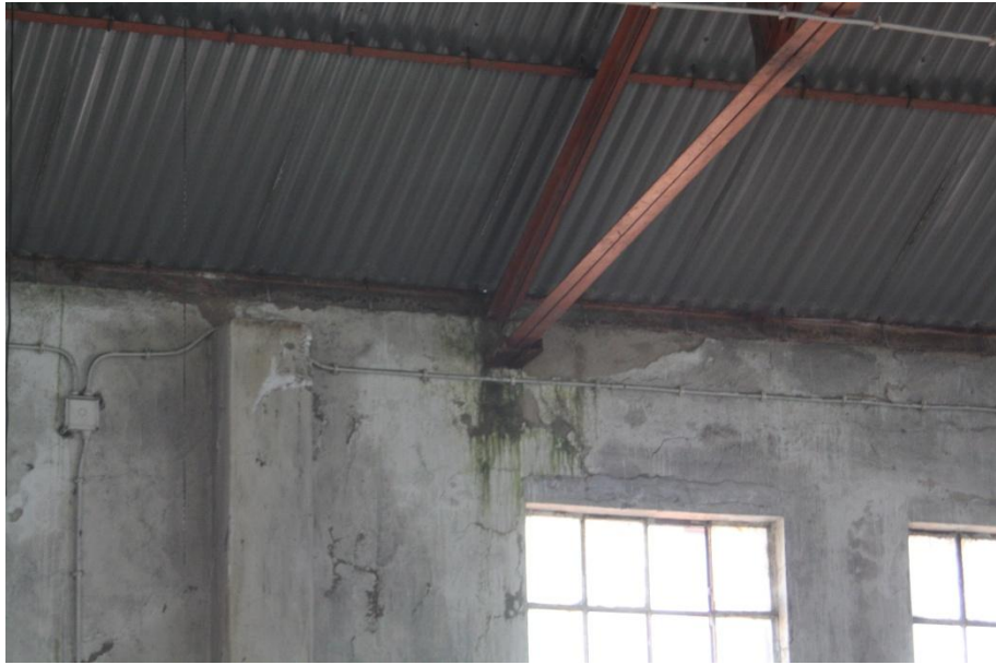
Figura 82 – Piso 4: Estrutura metálica da cobertura não assenta sobre os pilares
