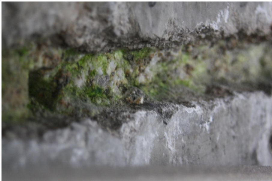
Figura 75 – Sulco num element de alvenaria com reboco em que se nota o aparecimento de material biológico.
