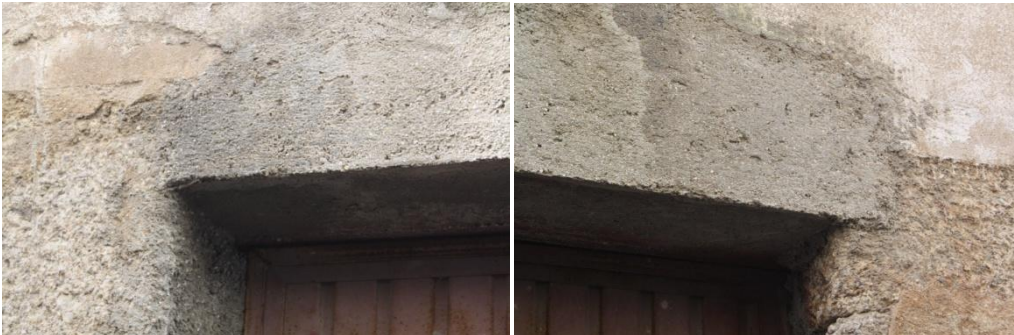
Figura 65 – Viga de encabeçamento de uma porta com extensão insuficiente para o bom desempenho da sua função, uma vez que mal apoia nos elementos de alvenaria
