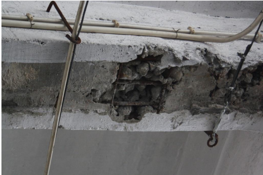
Figura 76 – Viga com integridade comprometida: armaduras à vista e má qualidade dos agregados empregues na sua execução
