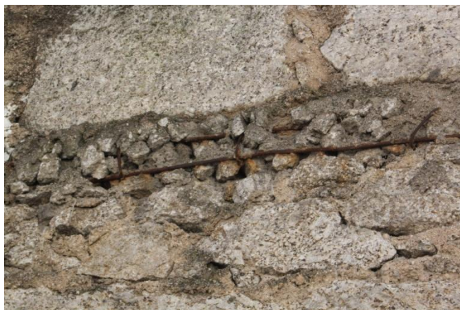
Figura 66 - Pormenor de viga de cintamento em betão ao nível da laje na zona de alvenaria estrutural, com a armadura a descoberto
