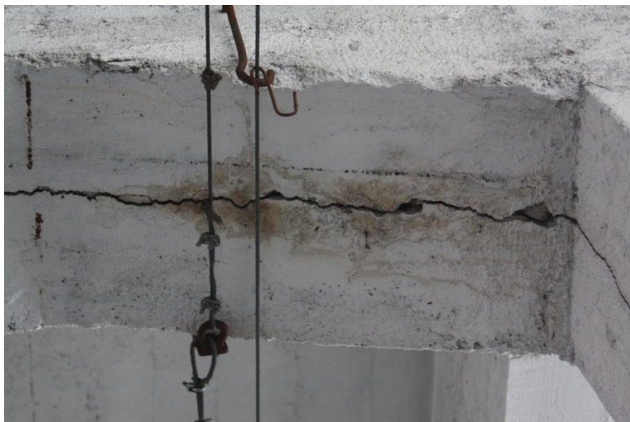
Figura 80 – Fractura continua em viga onde se notam também manchas acastanhadas que podem significar a oxidação e corrosão das armaduras
