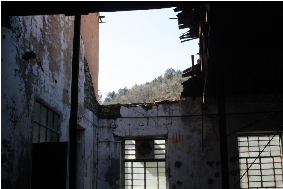
Figura 56 – Vista interior da zona poente do edifício com grandes danos devidos a um incêndio ocorrido há poucos anos
