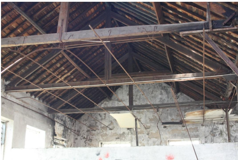
Figura 58 - Zona Poente do edifício bastante degradada
