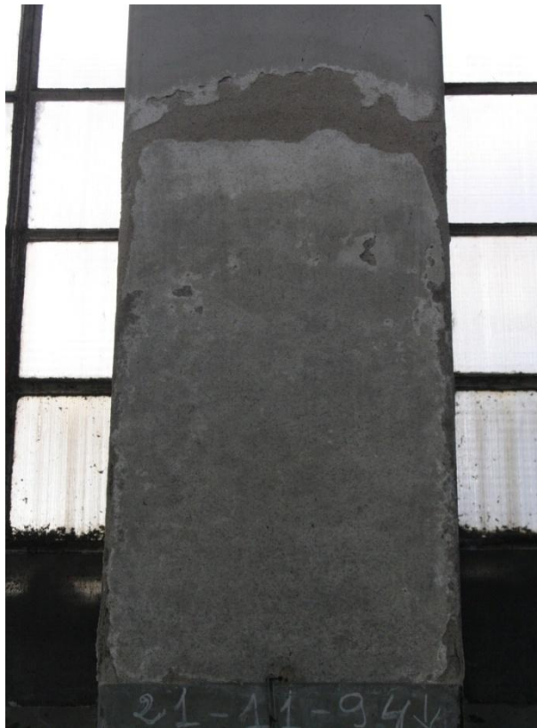
Figura 72 – Presença de salitre e humidade nos pilares e paredes da fachada Norte, pouco exposta à luz solar
