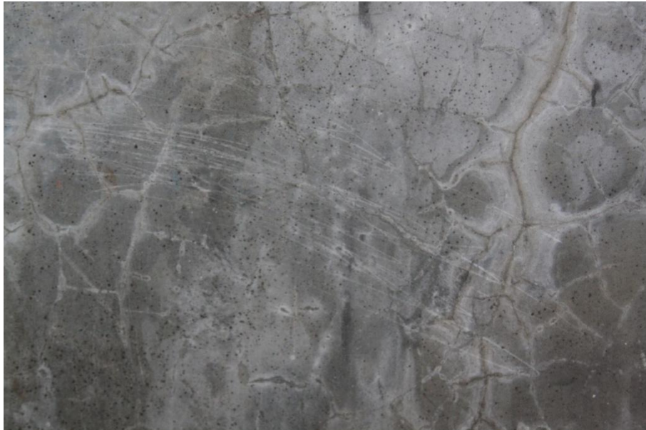
Figura 74 – Padrão de fissuração, frequente nas paredes do edifício, possivelmente devido a problemas no carregamento da estrutura
