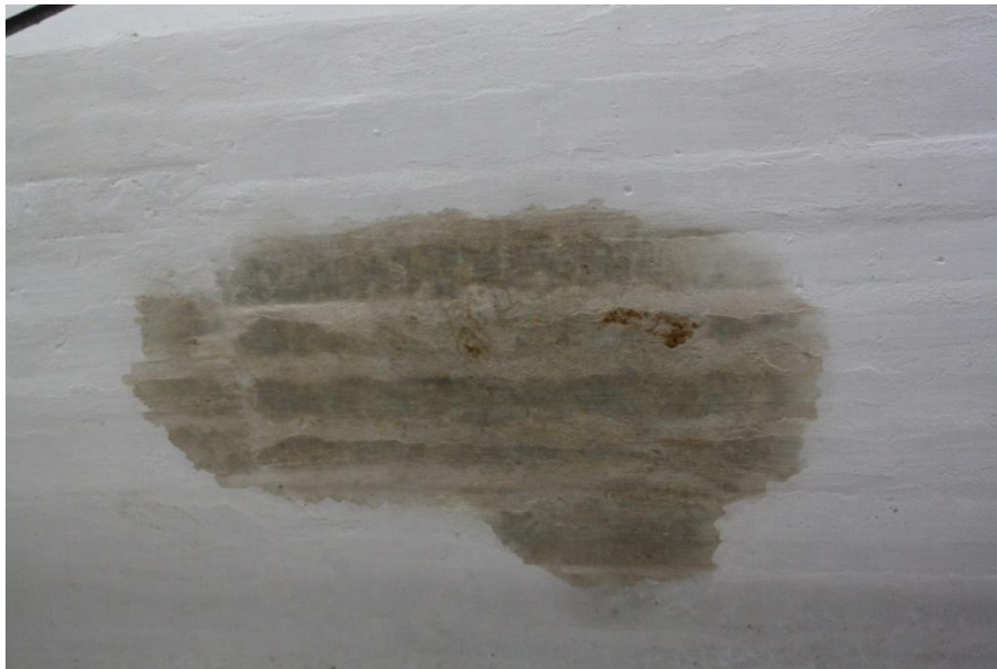
Figura 70 – Mancha de humidade presente em várias regiões do edifício, devidas a infiltrações causadas pelo mau estado da cobertura
