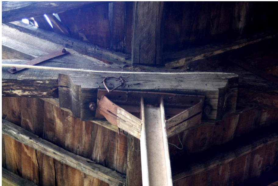
Figura 85 - Elementos de madeira apodrecidos e ligação a perfil metálico
