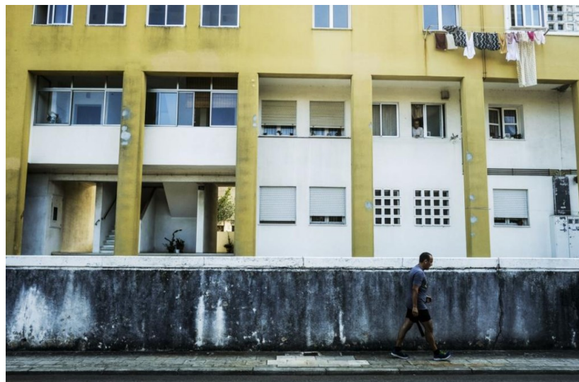
Figura 89 - Área de estacionamento comum com vias sem manutenção (Web 89, jul. 2017)
