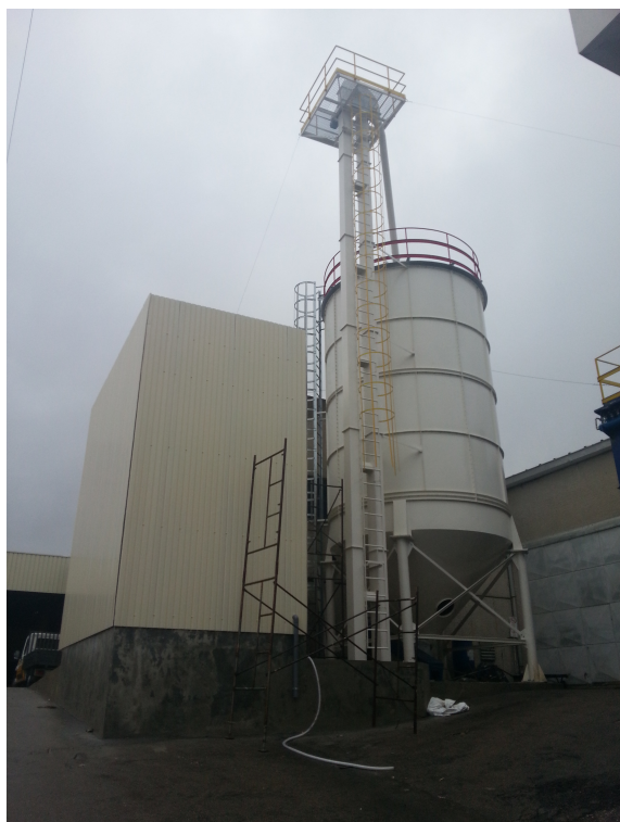
Figura 5.3.9. Silos para armazenamento de pellets de biomassa, que fazem a alimentação de uma caldeira de vapor.
