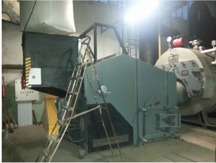
Figura 5.3.7. Outro tipo de queimador de biomassa numa caldeira de vapor que utiliza pellets de biomassa. Neste conjunto queimador/caldeira os pellets de biomassa são fornecidos em big-bags , colocados numa tremonha superior ao queimador.
