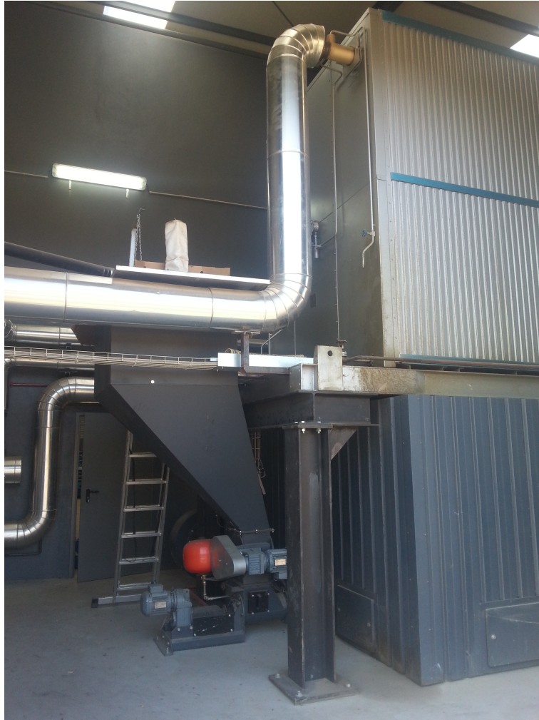
Figura 5.5.11. Caldeira de óleo térmico equipada com uma fornalha de biomassa, que se encontra a queimar pellets de biomassa torrificada desde Maio de 2014. Estima-se que tenham sido consumidos cerca de 200 toneladas de pellets de biomassa torrificada nesta caldeira.
