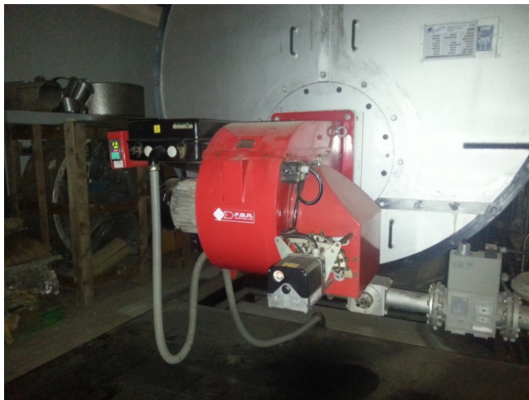
Figura 5.3.2. Queimador a gás propano numa caldeira a vapor.
