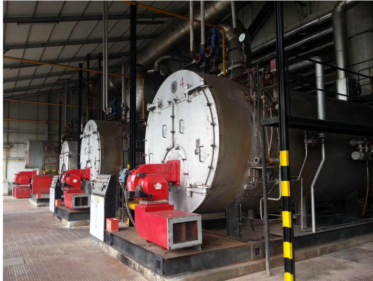
Figura 5.3.5. Sala de caldeiras de uma grande unidade de produção têxtil no Norte de Portugal.
