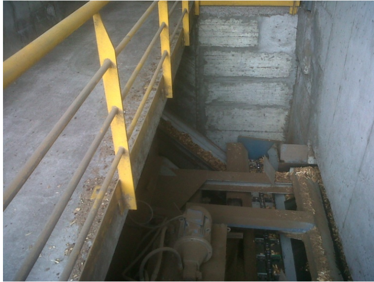
Figura 5.3.13. Sistema automático de alimentação de estilha de biomassa. Nesta figura apresenta-se o sistema de transporte de estilha de biomassa para o queimador.
