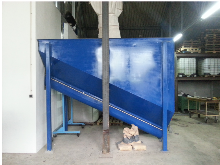
Figura 5.1.7. Sistema a pellets de biomassa numa empresa de tinturaria no Norte de Portugal - sistema de fornecimento dos pellets de biomassa.
