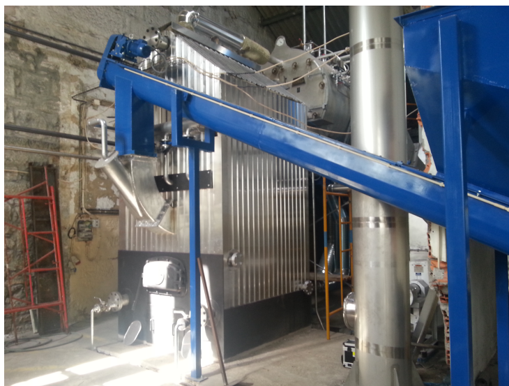
Figura 5.1.8. Sistema a pellets de biomassa numa empresa de tinturaria no Norte de Portugal - caldeira de vapor.
