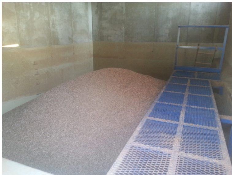
Figura 5.3.10. Sistema automático de alimentação de pellets de biomassa. Nesta figura apresenta-se o depósito de pellets de biomassa.
