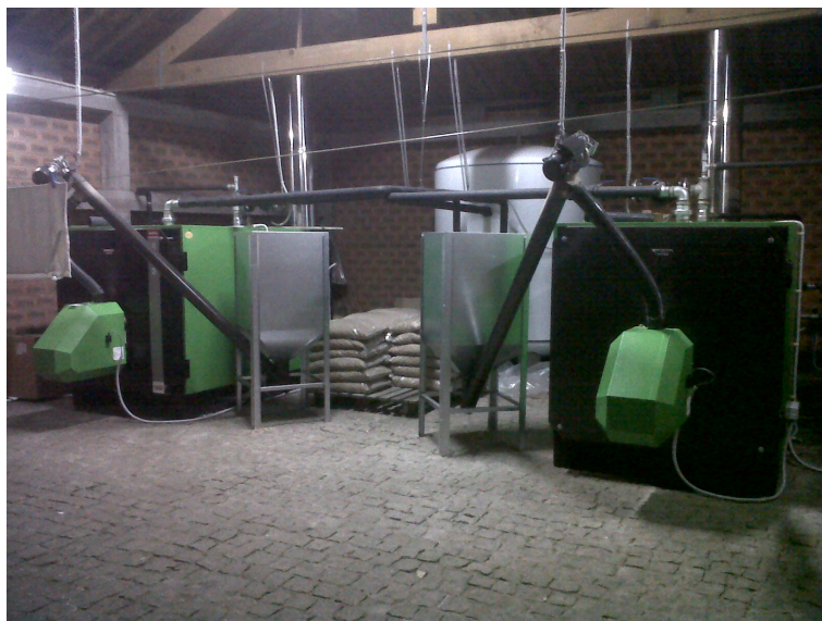
Figura 5.1.3. Exemplo de um sistema de aquecimento instalado num lar de 3 a idade no Norte de Portugal. O conjunto é formado por duas caldeiras de 150 kW e um depósito de inércia de 4.000 litros de água e um depósito de 300 litros de combustível para cada caldeira, que trabalham alternadamente.
