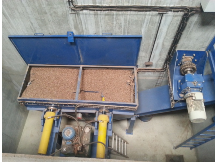
Figura 5.3.11. Sistema automático de alimentação de pellets de biomassa. Nesta figura apresenta-se o sistema de transporte dos pellets de biomassa para o queimador.
