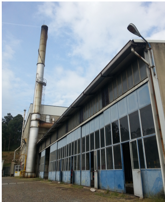
Figura 6.4.2. Aspeto de uma chaminé industrial que faz a emissão para a atmosfera de um conjunto de caldeiras de vapor e de óleo térmico de uma unidade industrial de tinturaria têxtil de grandes dimensões, localizada no norte de Portugal.
