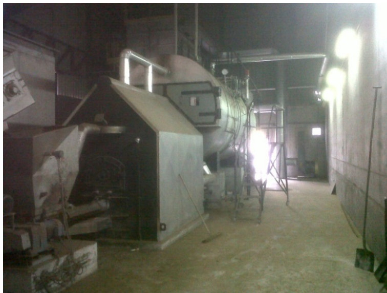
Figura 5.3.8. Queimador de biomassa numa caldeira de vapor que utiliza estilha de biomassa.
