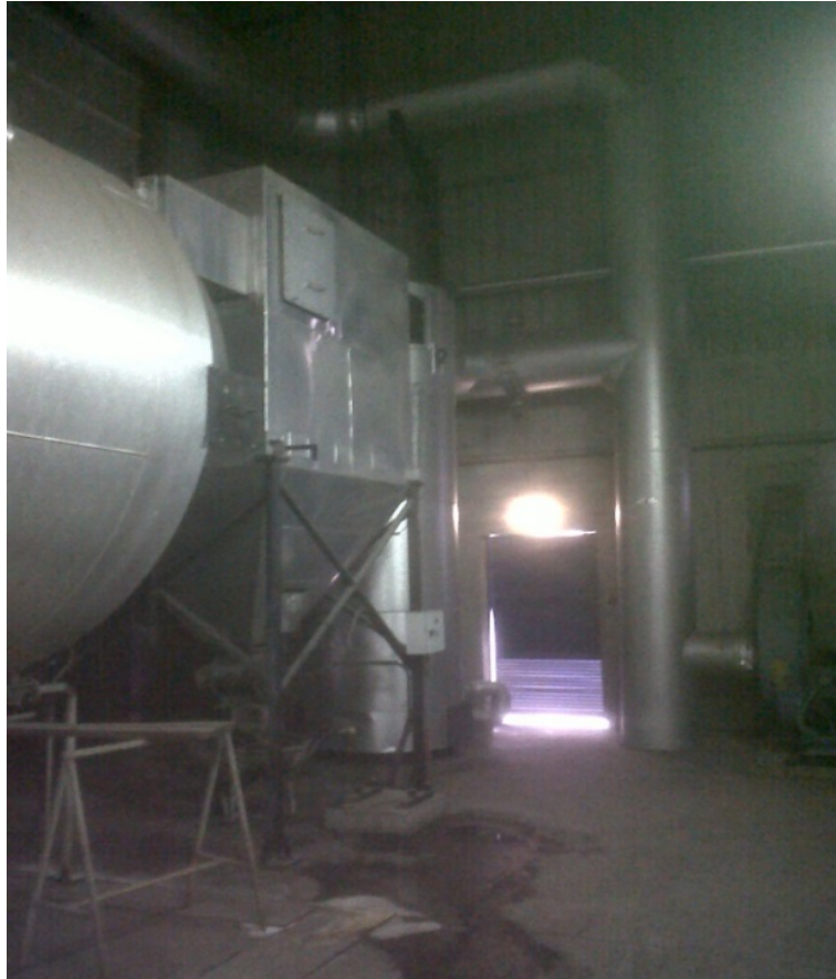
Figura 5.3.15. Sistema de filtragem de partículas (filtro de mangas).
