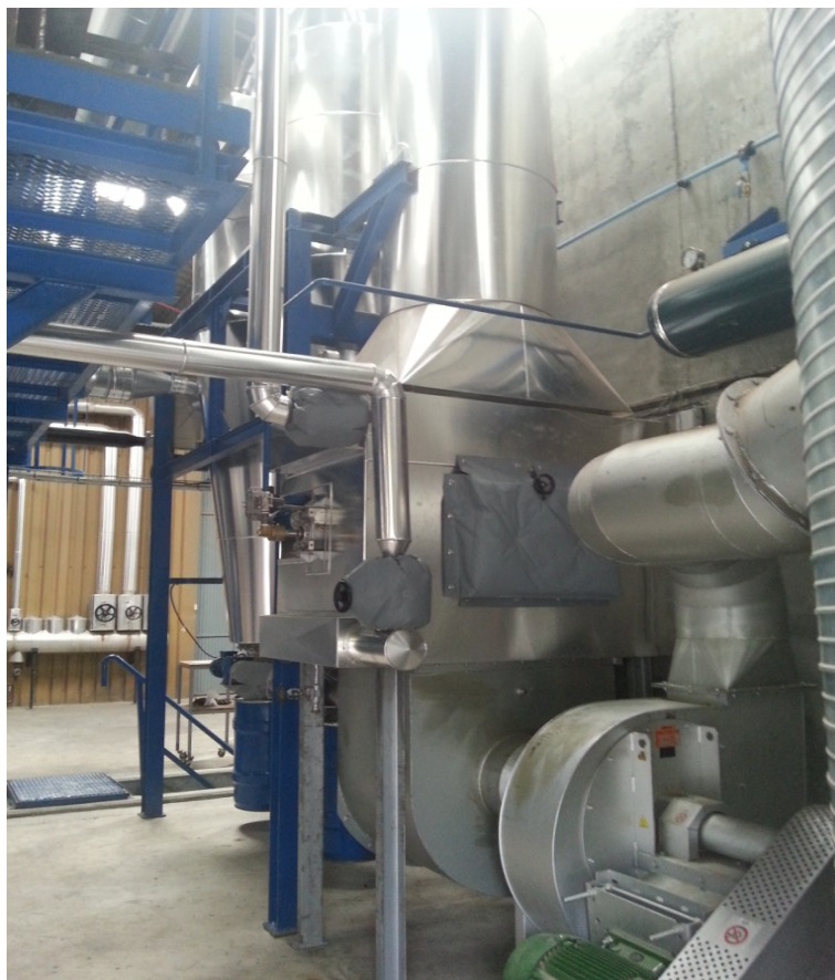
Figura 5.3.14. Sistema de filtragem de partículas (multiciclone) e economizador.
