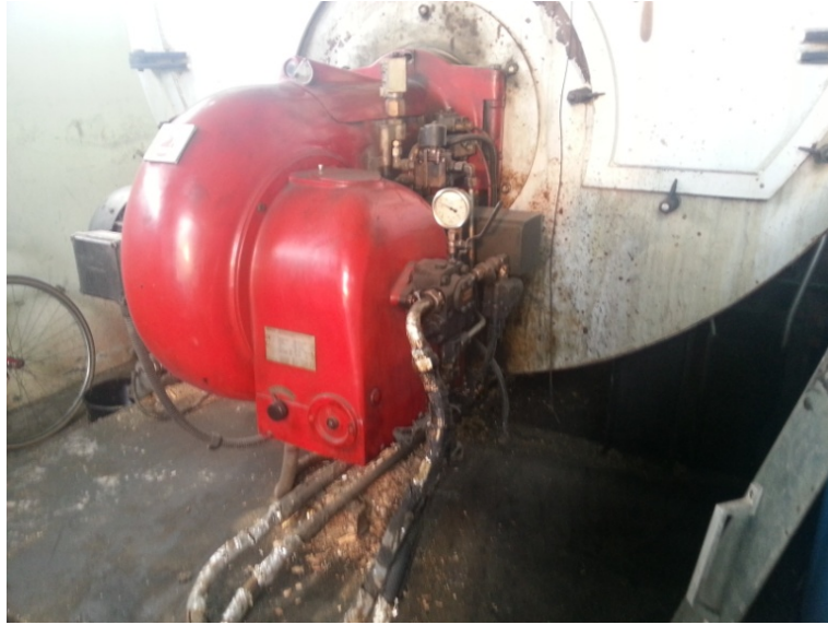
Figura 5.3.3. Queimador a nafta numa caldeira de vapor.
