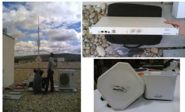
Figura 5.4 - Equipamento IEEE 802.16-2004 instalado na FCS-UBI.
