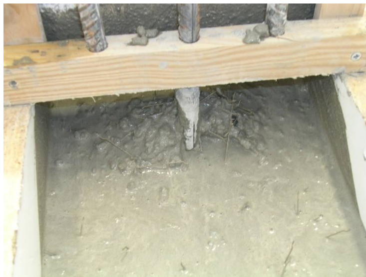
Figura 4.5 - Ligeiro bloqueio por acção das fibras de aço (mistura L; m=5,50 ; SP=2,84\% ; V_f=1,00\% )
