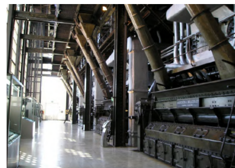
Figura 70 - Área de caldeiras do Museu da Eletricidade
