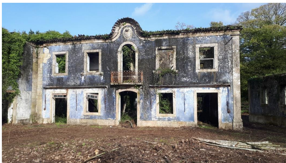
Figura 35– Fotografia da ruína da fachada do Grande Hotel do Pezo.
