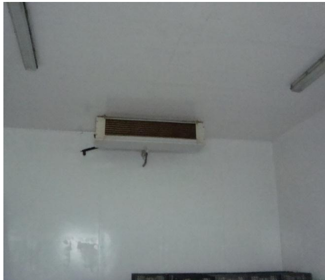
Fig.4.20-Evaporador da segunda câmara de primeira fase de cura.
