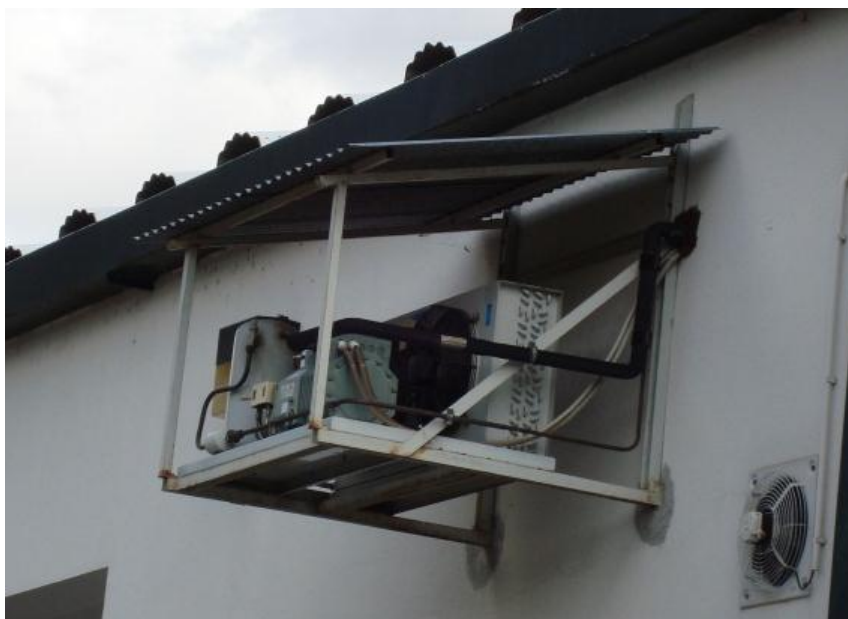
Fig.5.6-Compressor e ventiladores do condensador da câmara.
