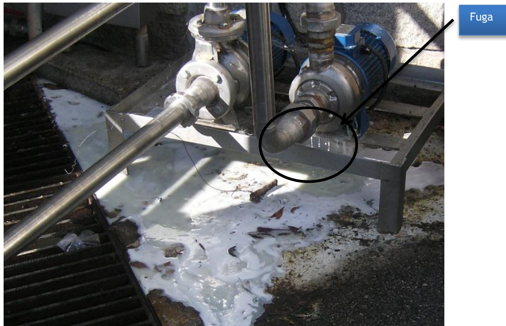
Fig.4.43-Fuga numa bomba de soro sobranete.
