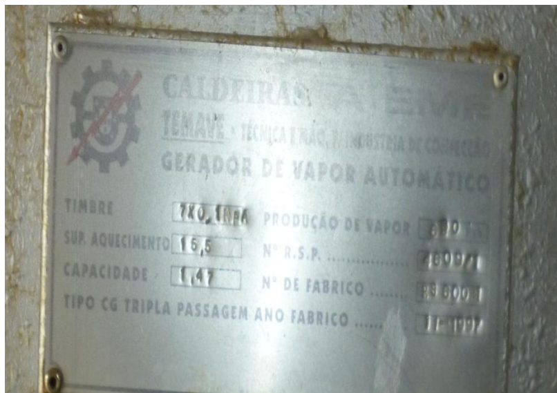
Fig.4.39-Chapa característica da caldeira.
