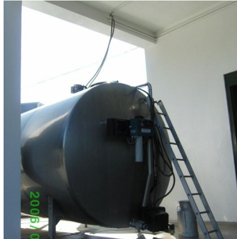
Fig.5. 2- Tanque de refrigerado.
