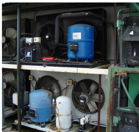
Fig.4.4-Grupo de condensadores para os tanques.
