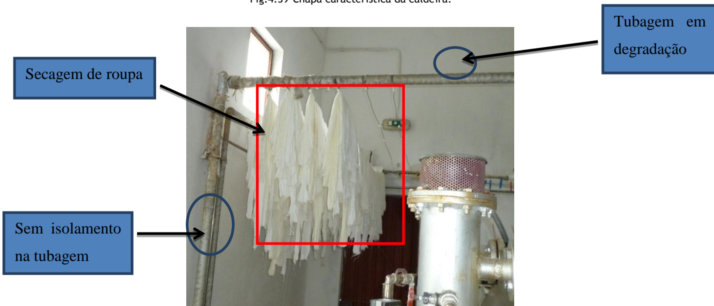
Fig.4.40- Tubagem da caldeira.
