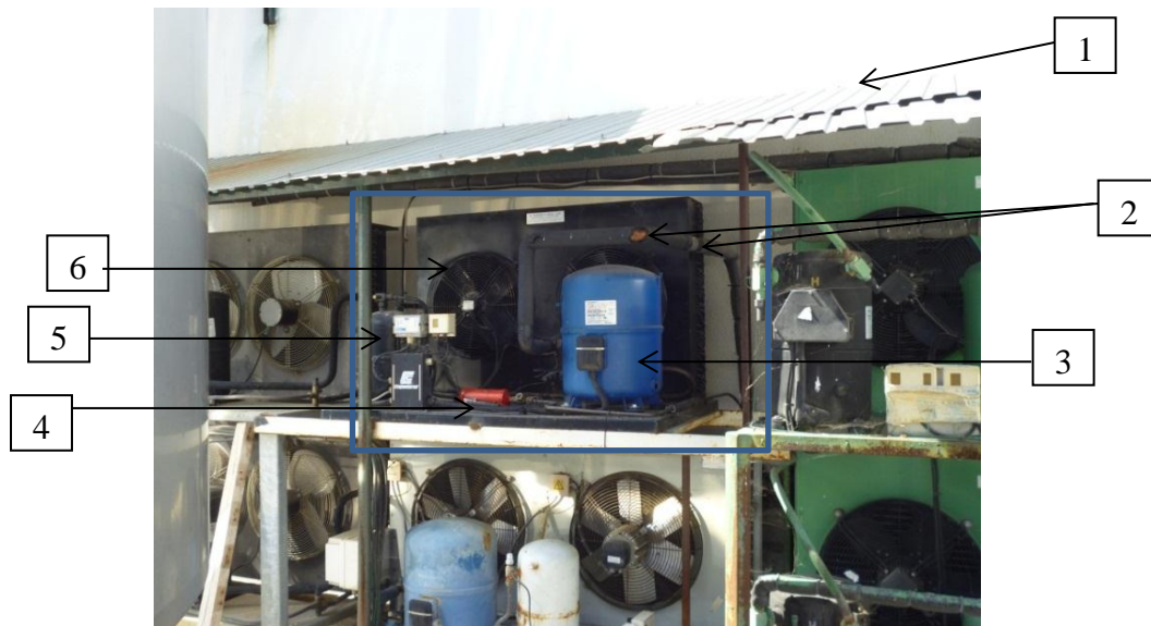
Fig.5. 3 Compressor e ventiladores do condensador do tanque.
