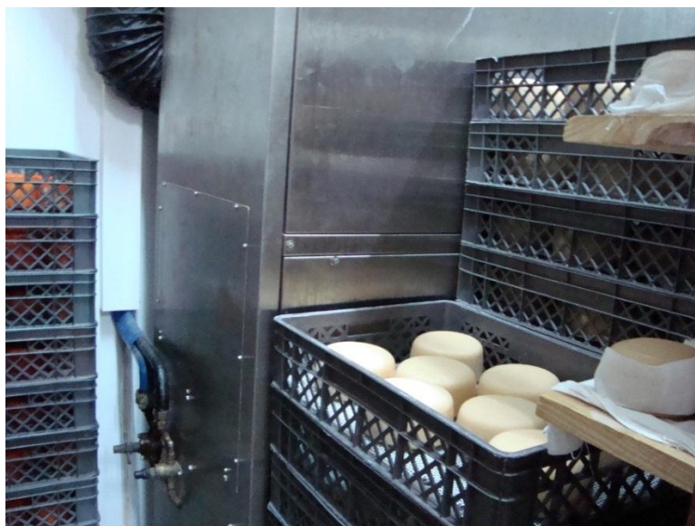
Fig.4.44-Por fim foi também verificado formação de gelo no evaporador da câmara de requeijão
