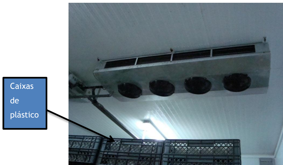
Fig.4. 18-Evaporador da câmara 1 fase de cura.
