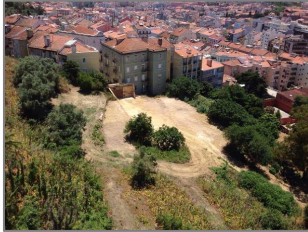
Figura 5: Vista após demolições dos armazéns no centro do Caracol da Penha. (Alemão, 2016b).
