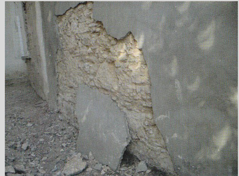
fig. 64 – Lisboa. Pintura incompatível de cimento em edifício público do séc. XIX.
