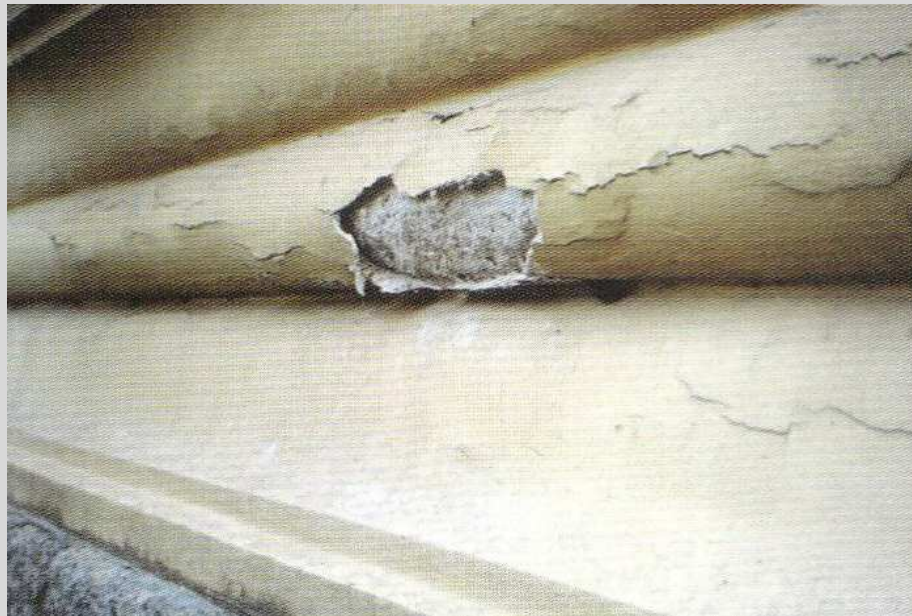
fig. 63 – São Paulo, Brasil. Pintura incompatível em palácio do séc. XIX.
