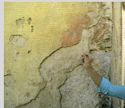
fig. 67 – Reboco de um Hospital em Lisboa (séc. XIX). Pormenor das várias camadas do reboco.
