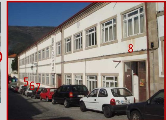
fig. 75 – Alçado principal. Levantamento de patologias. Tipos de agravamentos e seu estado.
