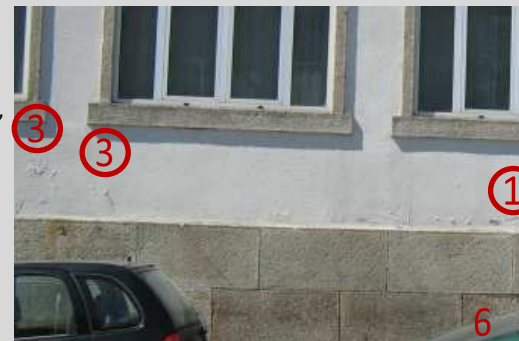
fig. 78 – Tipo 1: separação da camada exterior do reboco, estado muito avançado. Tipo 3: separação da camada exterior do reboco, estado avançado.
