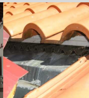
fig. 52 – À esquerda, visão interior da ala Sul. Veja-se a estrutura da cobertura em treliças metálicas. À direita, imagem da subtelha do género ONDULINE seguida de mais uma camada de placas de poliestireno extrudido.
