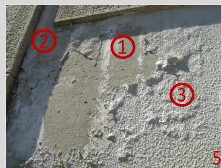
fig. 76 – Tipo 1: separação da camada exterior do reboco, estado muito avançado. Tipo 2: destacamento da pintura, estado muito avançado. Tipo 3: separação da camada exterior do reboco, estado avançado.
