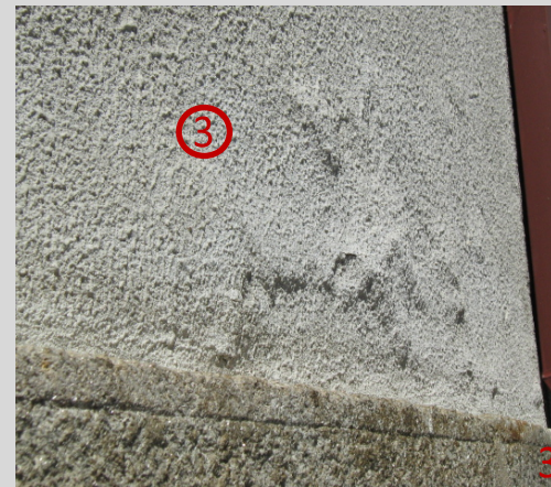
fig. 73 – Tipo 3: separação da camada exterior do reboco, estado avançado.
