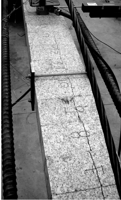
Figura 108: Vista parcial da microfissura com 1,9 m de comprimento [2].
