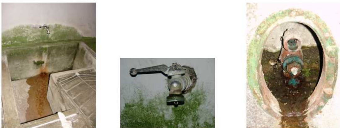
Figura 6- Exemplos de perdas de água em acessórios da rede de distribuição (Antunes et al. , 2009)
