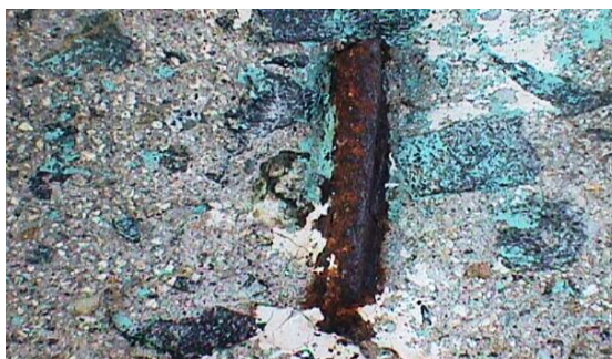
Figura 10 - Ataque de sulfatos ( http://icc.ucv.cl/hormigon/fotospat.html )
