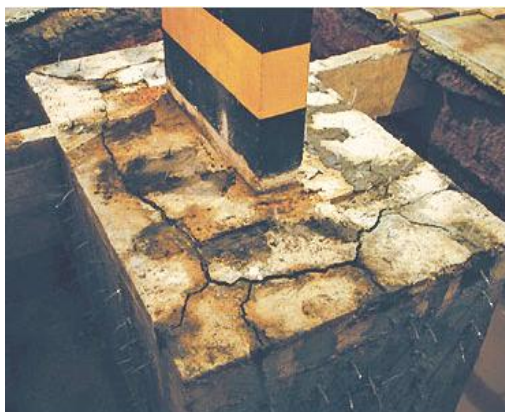
Figura 13 - Fissuração provocada pela reacção álcalis ( http://www.revistatechne.com.br )
