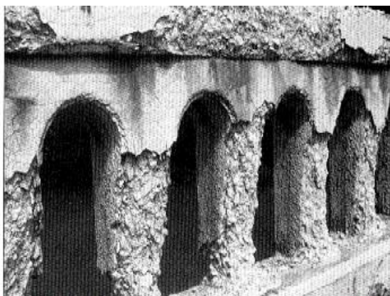
Figura 16 - Destacamento do betão devido à acção do gelo ( http://www.concrete-experts.com/ )
