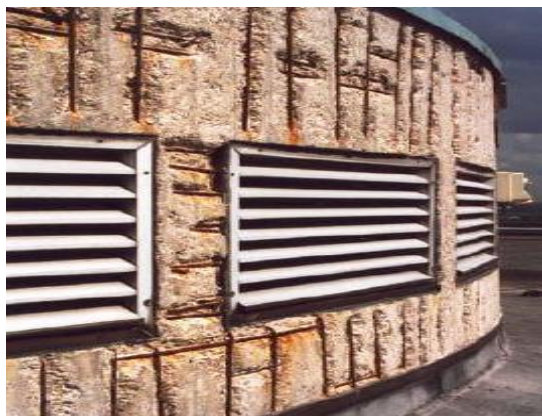
Figura 7 - Deterioração do betão por acção da carbonatação (Simas, 2007)
