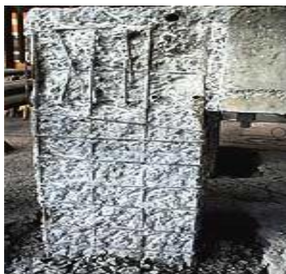
Figura 9 - Degradação do betão devido ao ataque dos ácidos ( http://www.revistatechne.com.br/ )
