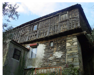
i) Sem revestimento
