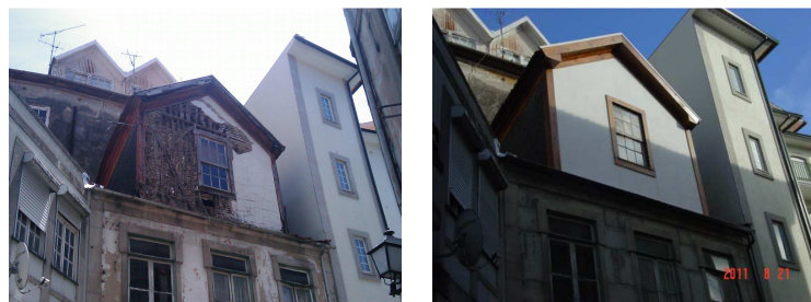
a) Paredes degradadas
