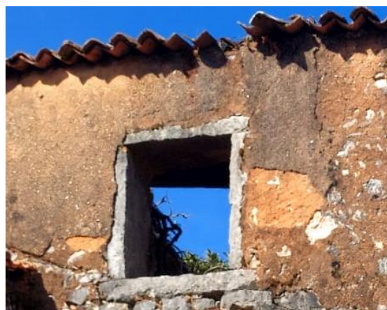
Fig. 86 _ Telhas canudo em habitação abandonada, aldeia de Ereiras (2025)
