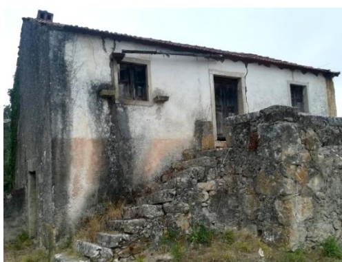
Fig. 61_ Pequena habitação em ruína com acesso ao piso superior por escadas em pedra, aldeia de Jagardo, freguesia de Redinha (2025)
