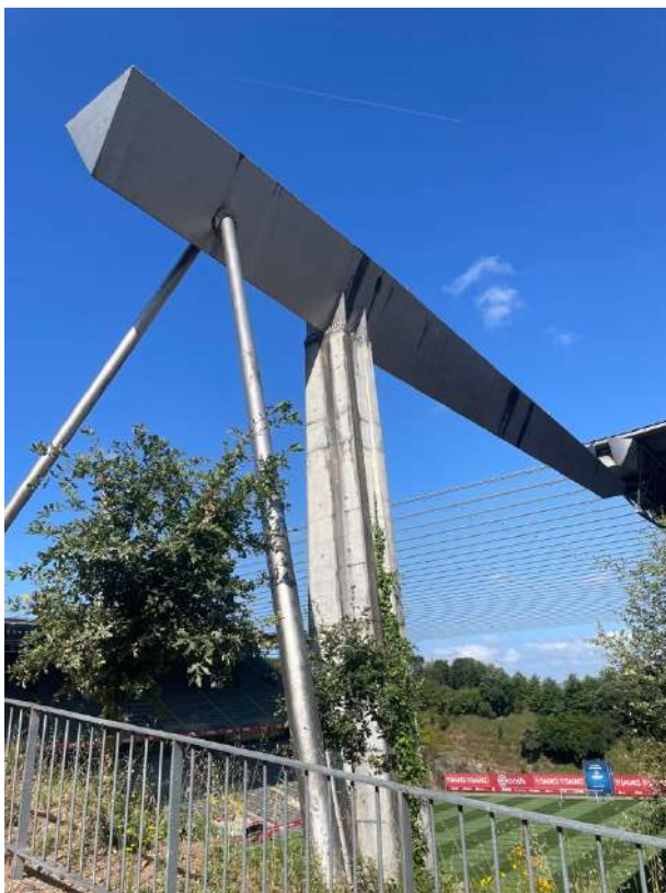
Momento de captação das águas pluviais
