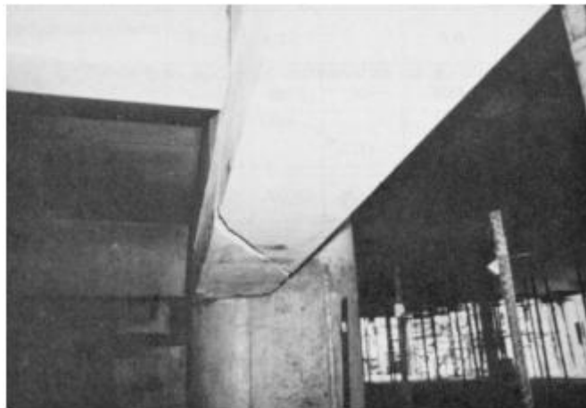
Figura 1.4 - Rotura frágil por torção de uma viga num edifício [26]
