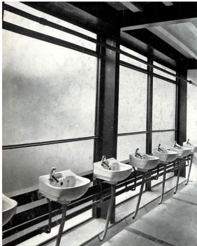
Figura 9 - Tubagens da água das instalações sanitárias, Escola Hunstanton, Alison e Peter Smithson, 1954.
