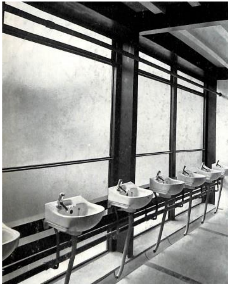
Figura 36 - Canalizações dos lavatórios das Instalações sanitárias, Escola Secundária de Hunstanton.
