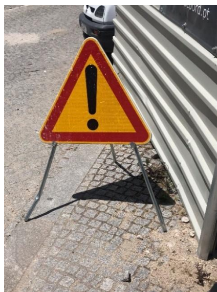
Figura 70- Sinalização de advertência a diversos perigos na proximidade da obra
