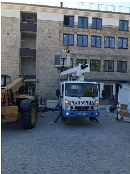
Figura 73- Solução de grua automóvel usada como alternativa de andaimes durante execução de trabalhos em fachadas
