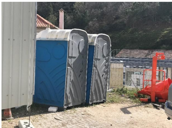
Figura 51- Instalações sanitárias do estaleiro
