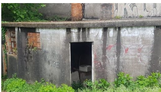
Fig.68 - Pormenor da sala do depósito de água.
