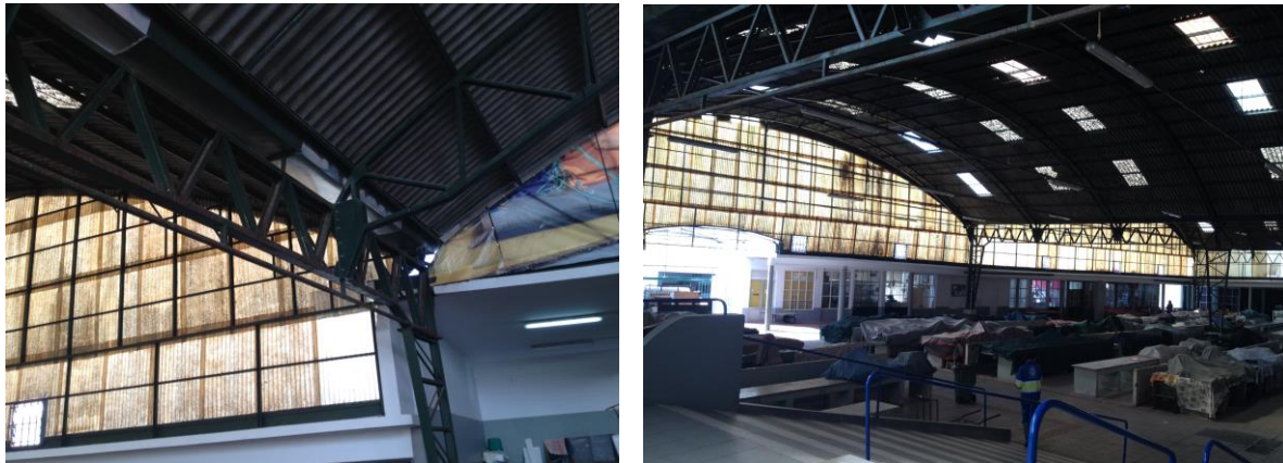
Figura 55 - Patologias diagnosticadas nos materiais constituintes da cobertura.
