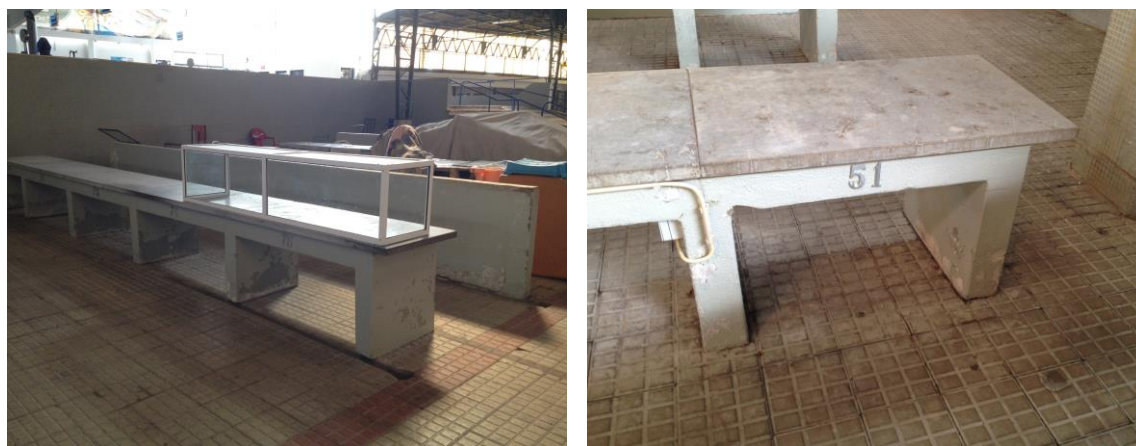
Figura 53 - Patologias diagnosticadas nos muros de separação do Mercado de produtos variados.
