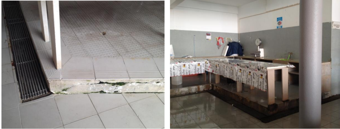
Figura 54 - Patologias diagnosticadas nas lajes de pavimento do Mercado de Peixe.
