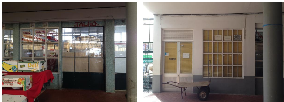
Figura 56 - Patologias diagnosticadas nas paredes interiores.
