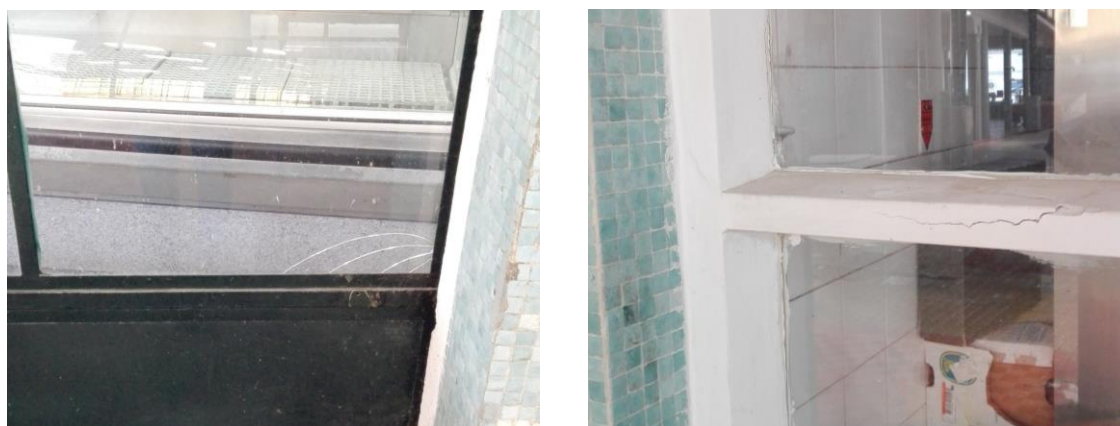
Figura 57 - Patologias diagnosticadas nas portas e janelas interiores.
