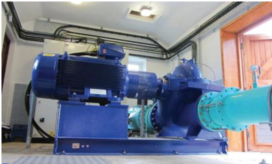
Figura 1.6: Aplicação do SynRM num sistema de bombagem industrial [9].
