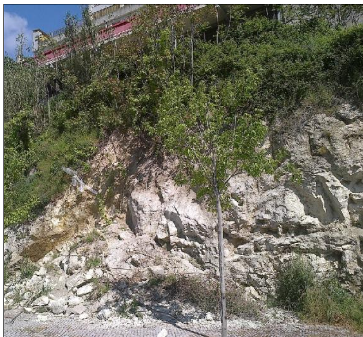
Figura 4.22 - Fotografia sobre o talude próximo do Elevador da Goldra, evidenciando a ocorrência de fraturas, por vezes muito lisas, na Unidade geotécnica GR.
