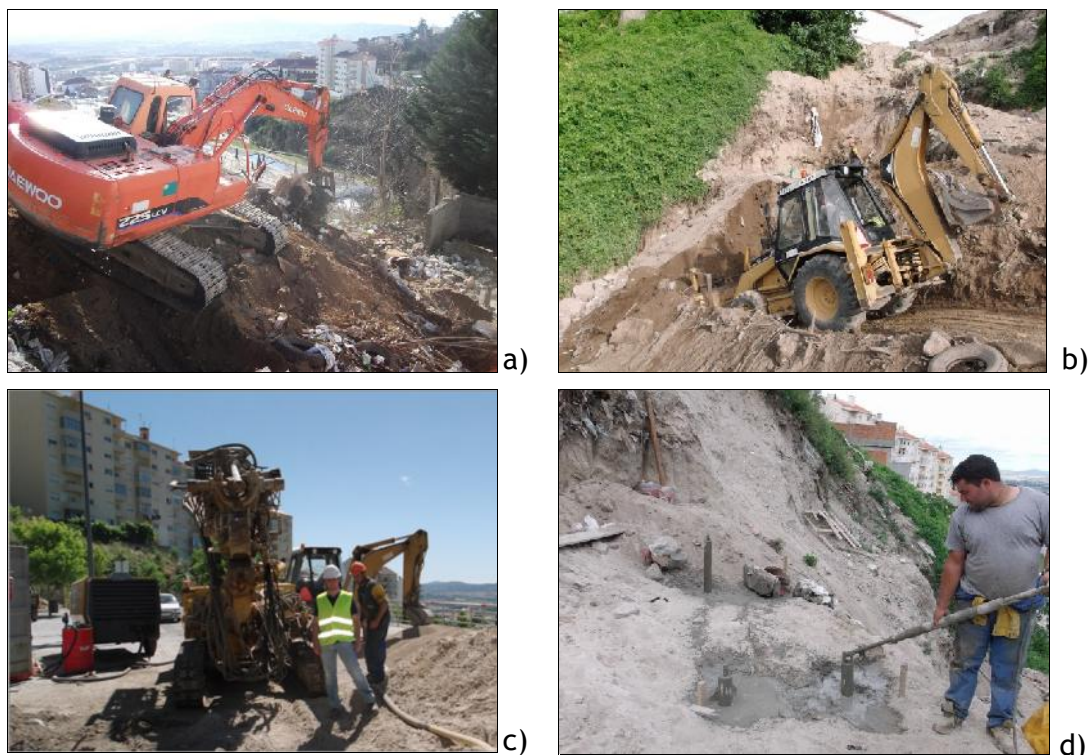
Figura 3.1 - Imagens sobre acompanhamento da obra; a) limpeza e decapagem de terreno; b) preparação de plataforma da paragem- terminal inferior; c) máquina de furação de microestacas; d) injeção de microestacas.
